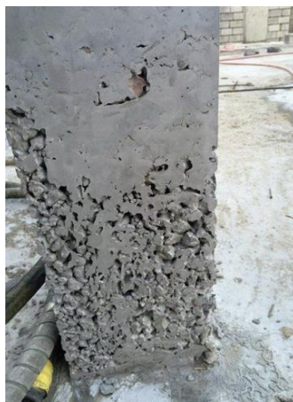
Figura 2. Prueba de segregación en el concreto. Fuente: INA construcción.
