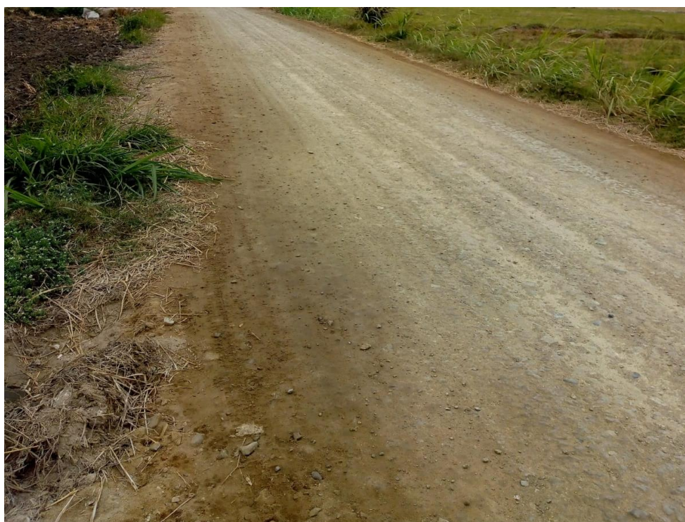
Figura 3: Estado actual de la vía del C.P. Naylamp a Lambayeque.
