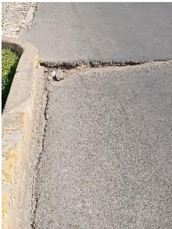
Figura 1. Presencia de deformaciones superficiales en el pavimento.
