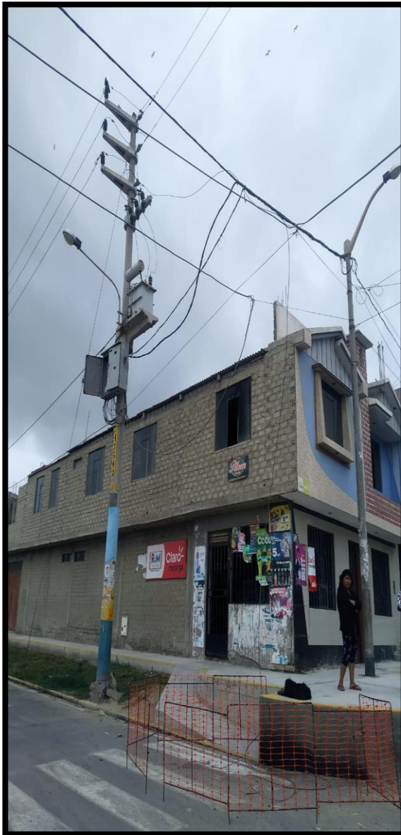
Figura 7: Vano de conductor Fase R caído entre las Estructuras CH0640 – E2042119
