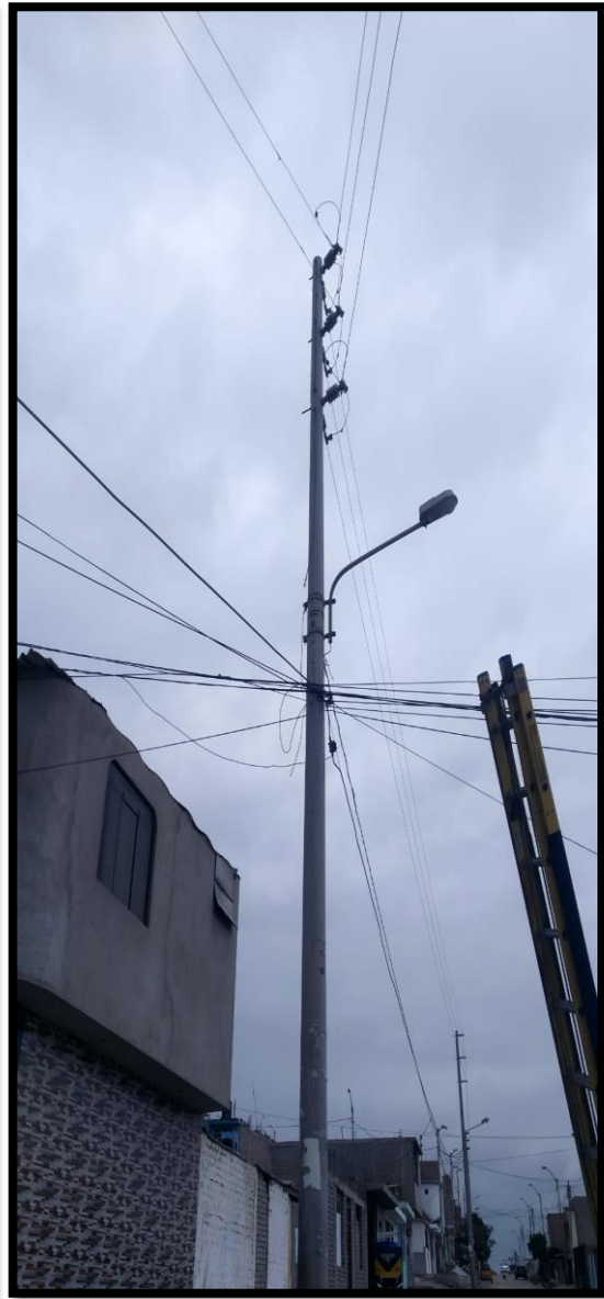
Figura 6: Estructura Nro. E2042119 origen de la línea caída por efecto Galvánico en la Fase R.
