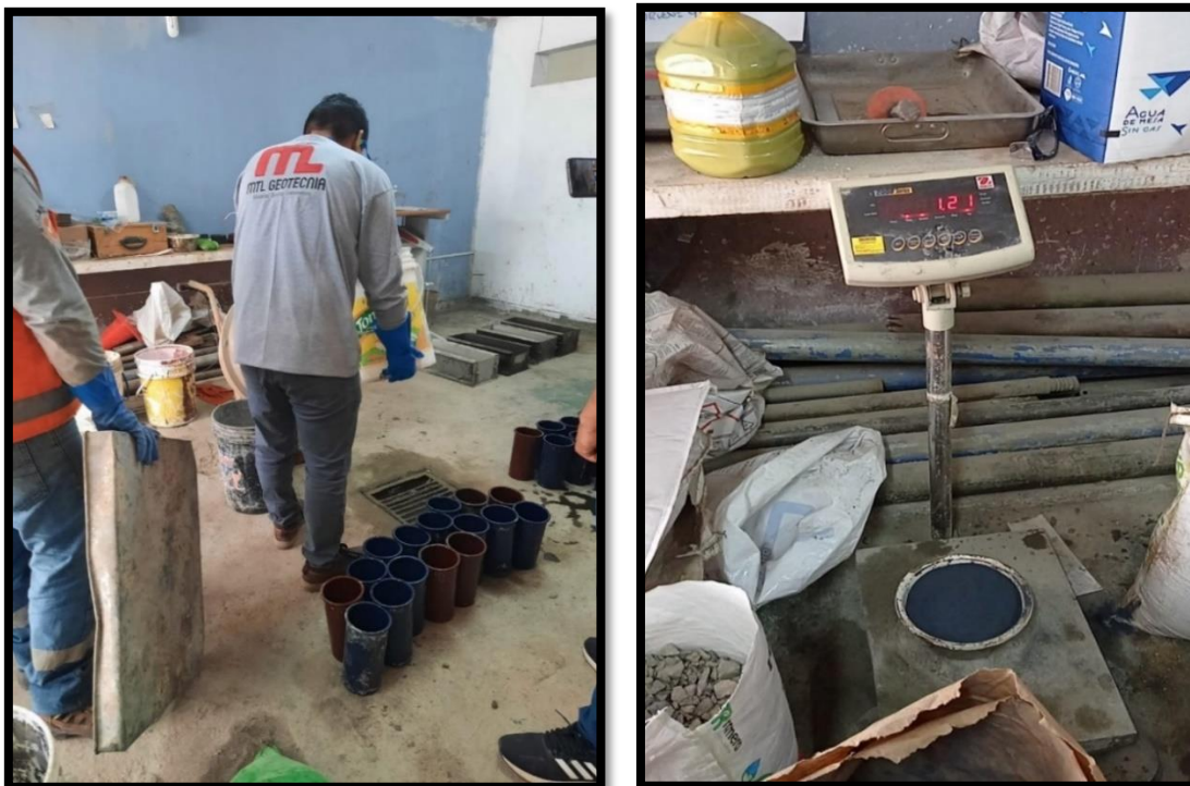
Figura 20. Incorporación de microsílíce con superplastificante para la elaboración del concreto estructural. Elaboración propia
