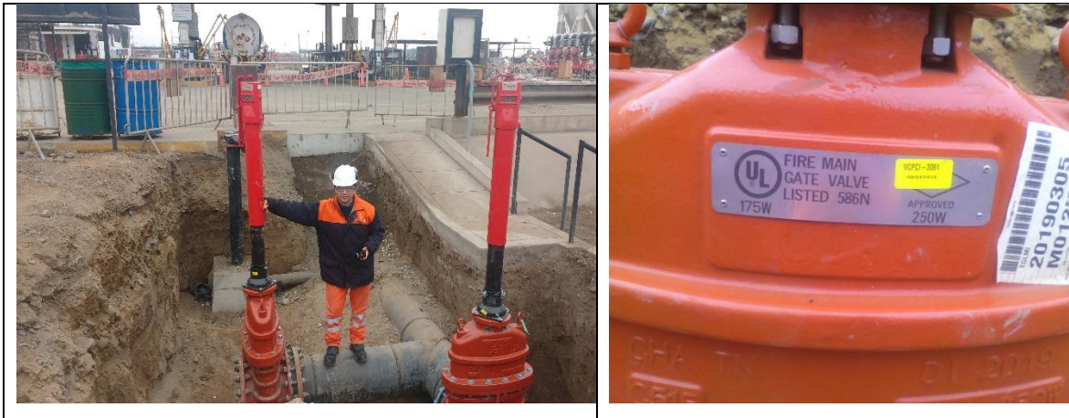
Figura 33. Válvulas del sistema contra incendio certificada por UL. Fuente: Elaboración propia.
