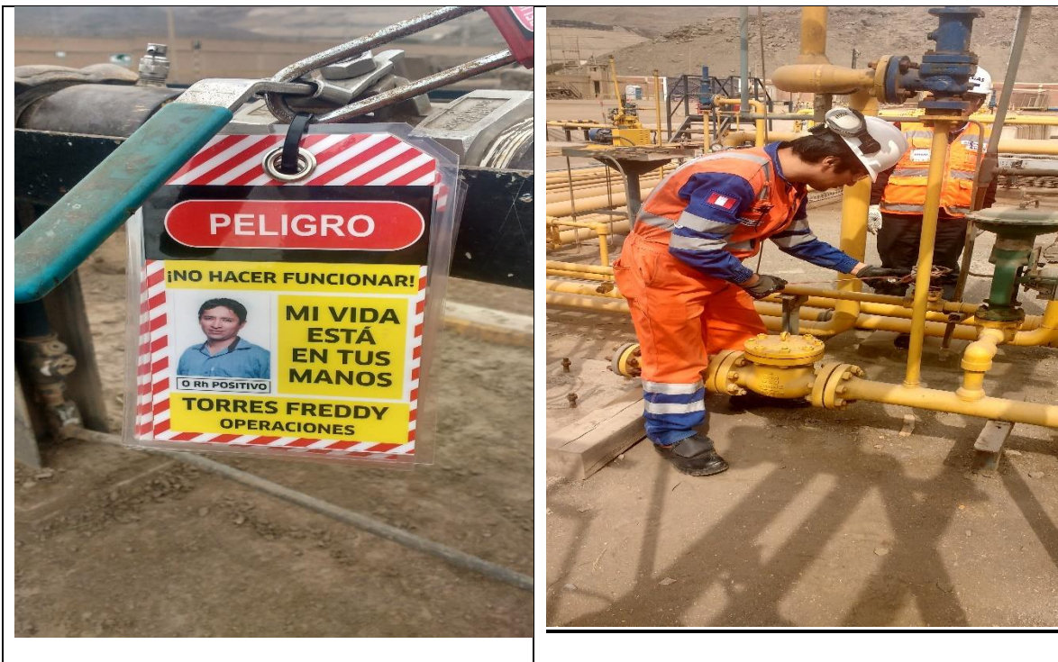
Figura 31. Bloqueo de válvulas de línea de descarga de unidades y succión de bomba. Fuente: Elaboración propia.
