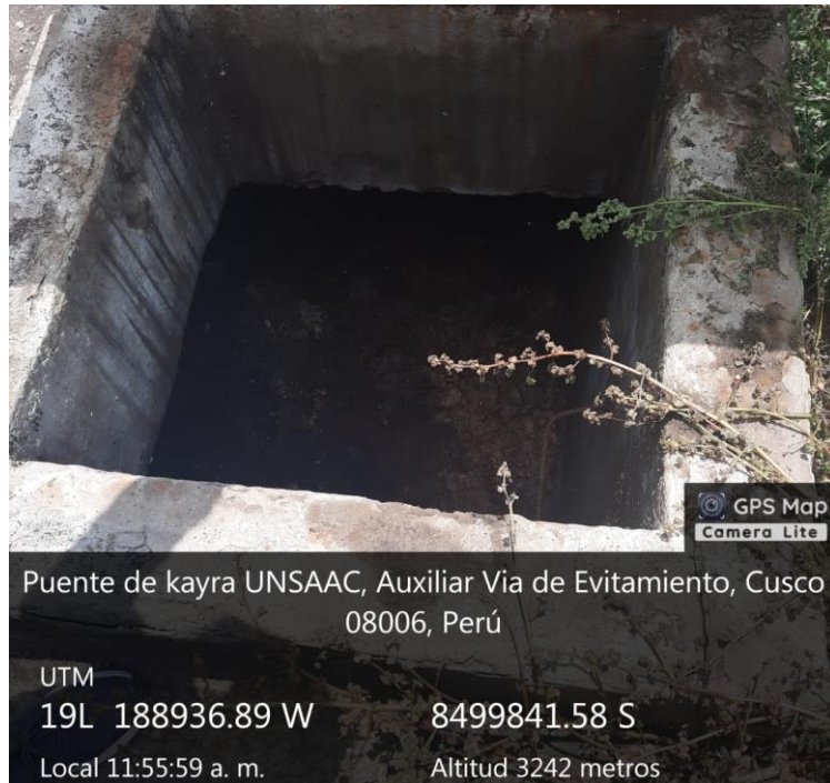
Foto 07 : Estado actual del sedimentador obstruido
