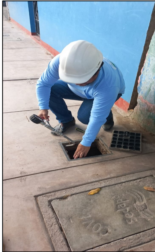
IMAGEN 01.- Toma de presiones en caja de registro de agua Conexión domiciliaria de ½"
