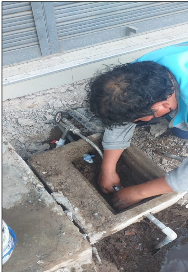
IMAGEN 03.- Toma de presiones en caja de registro de agua Conexión domiciliar de ½" sin medidor.
