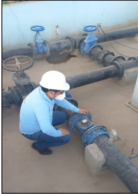
IMAGEN 07.- Revisando macro medidor de la Línea de aducción del R-450
