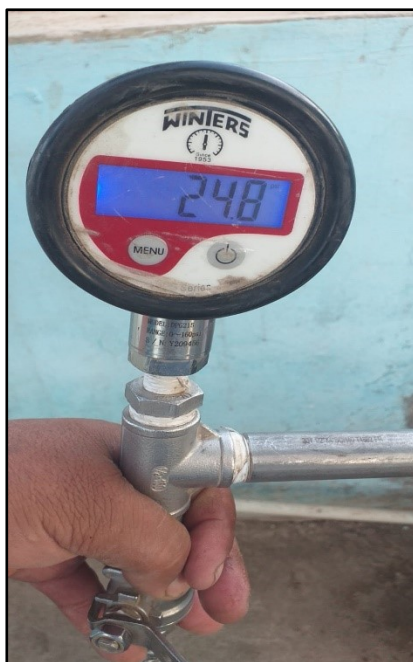
IMAGEN 04.- Presión en PSI - manómetro digital (Zona de alta presión)
