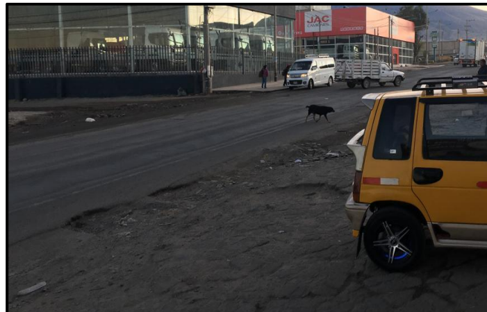
Figura 47: Falta de señalización Km. 3.00.
