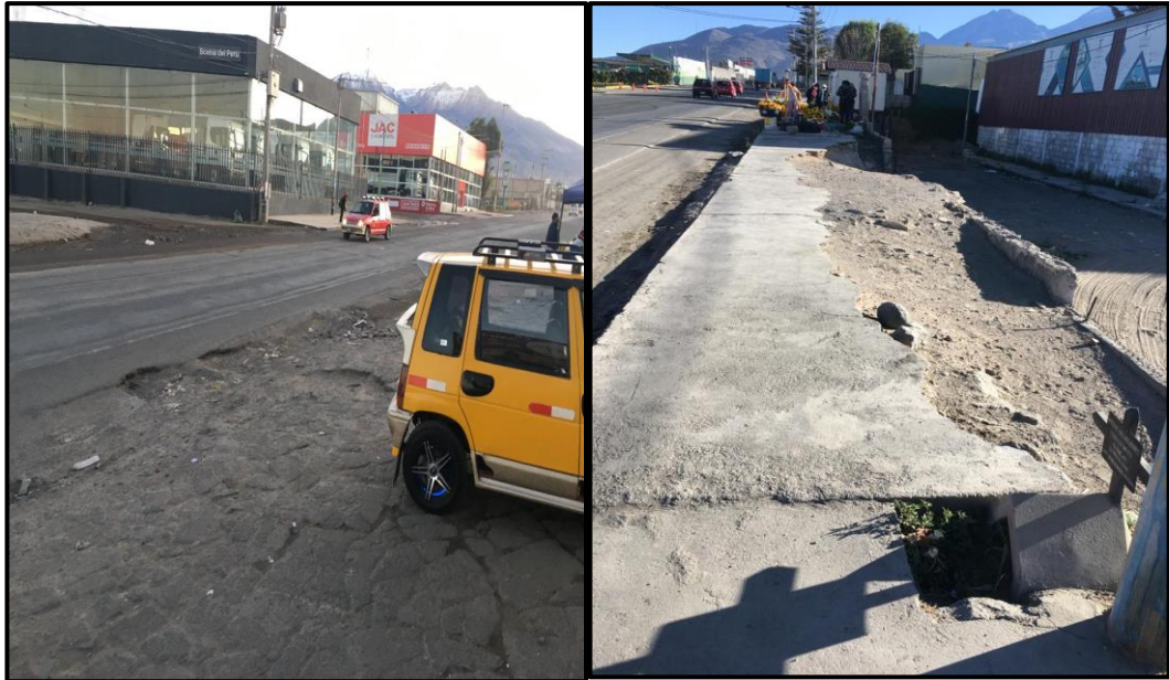
Figura 73: Falta de señalización y vía en mal estado Km. 3 y 4. Fuente: Del autor
