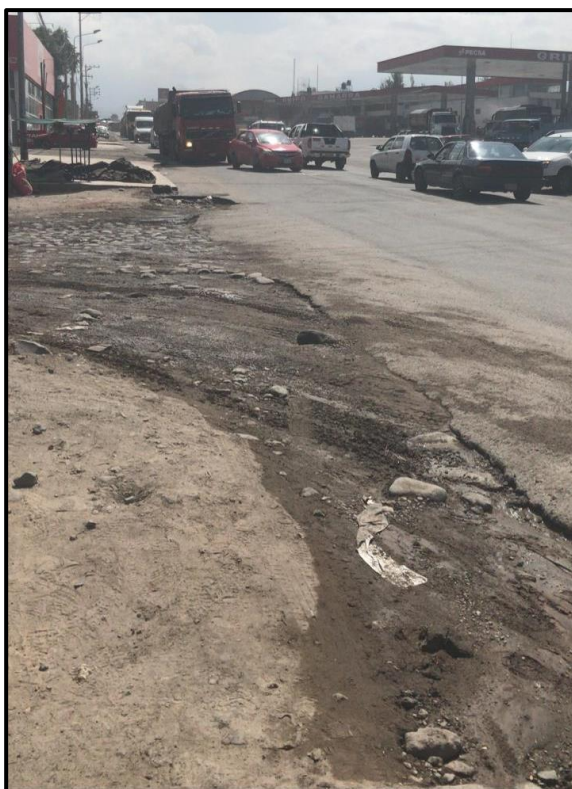
Figura 2: Falta de veredas y bermas.
