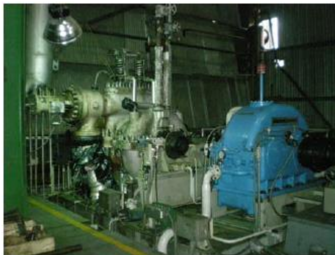
Turbina de vapor
