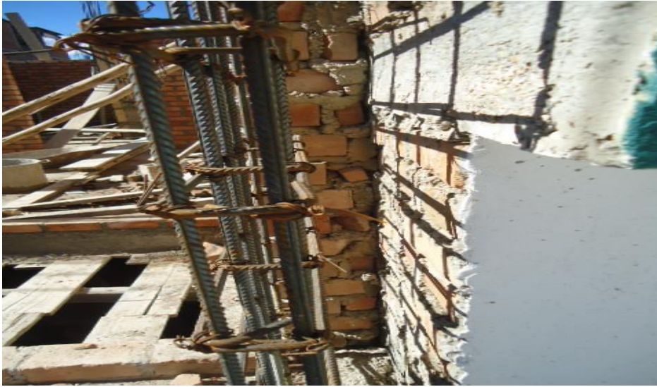
Fotografía N°1: Vivienda en construcción no tiene junta sísmica con la vivienda vecina ubicada en el Jr. Jerusalén s/n.
