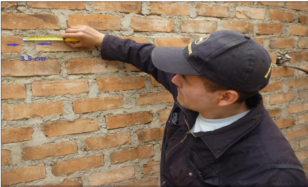
Figura N° 9: Espesor de 3.5 centímetros de la junta vertical en un muro de albañilería en la vivienda ubicada en el Jr. 23 de setiembre del sector de Mollepampa– Cajamarca.
