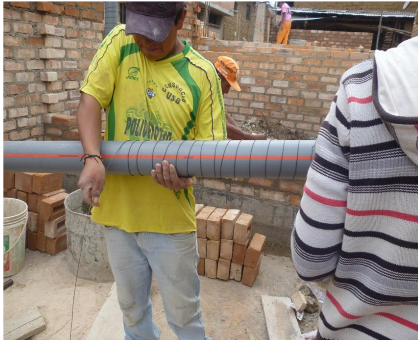
Fotografía N° 11: Forma correcta de envolver al tubo con alambre # 16, en la vivienda ubicada en la calle Carlos Malpica s/n.
