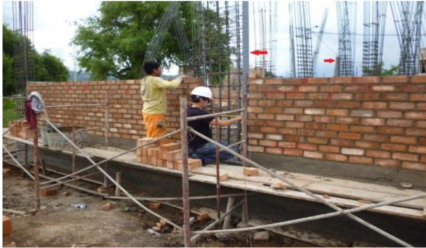
Fotografía N°5: La Norma E.070 (Albañilería) no permite alojar tuberías mayores a 55 mm en muros portantes de albañilería, en la vivienda ubicada en el Jr. Túpac Amaru.
