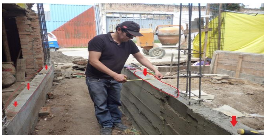
Fotografía N° 4: Superficie de concreto fraguado del sobrecimiento no rayado; por consiguiente no rugoso, vivienda ubicada en el Jr. Sánchez Hoyos.
