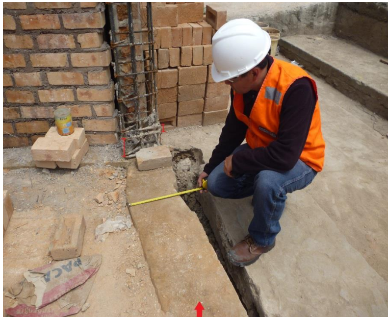
Fotografía N° 12: Concreto de sobrecimiento no rugoso, vivienda ubicada en el Jr. 23 de setiembre.
