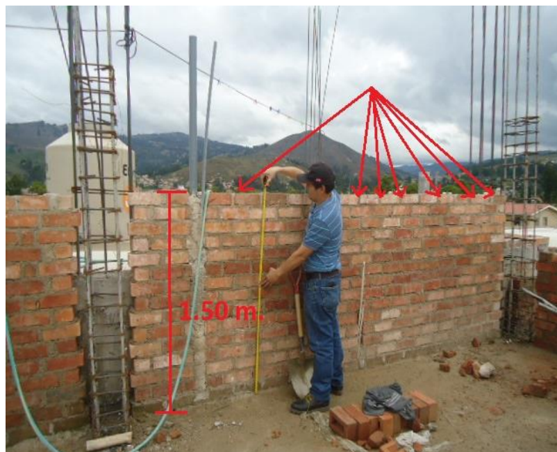
Fotografía N°3: La Norma E.070 (Albañilería) no permite asentar en una jornada de trabajo mayor a 1.30 metros de altura en muros portantes de albañilería. Además las juntas verticales llenas con mortero en una jornada de trabajo en una vivienda ubicada en Av. Jesús de Nazaret y Túpac Amaru.
