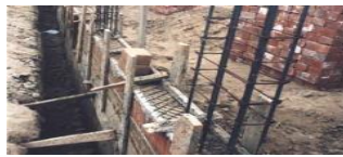
Figura N° 1: Rayado del concreto sobre el sobrecimiento.
