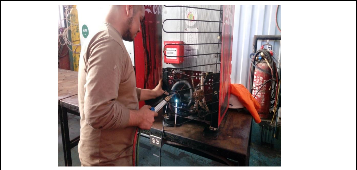
Mantenimiento de Refrigeración
