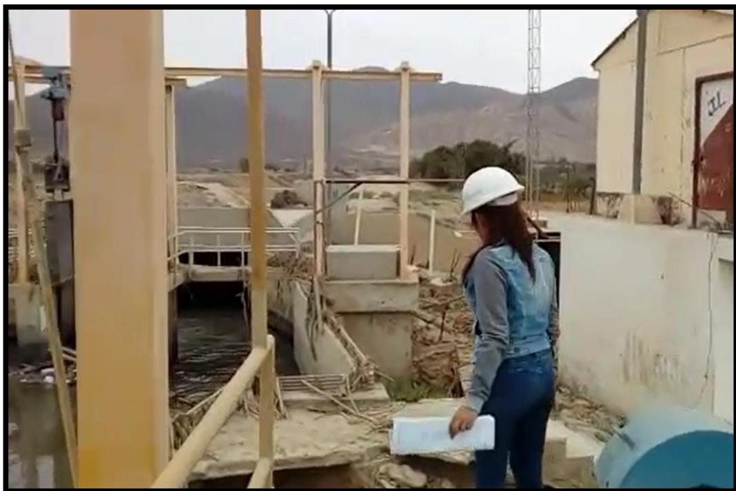
Imagen N°08: Botadero Cascajal, destruido por fenómeno del niño.
