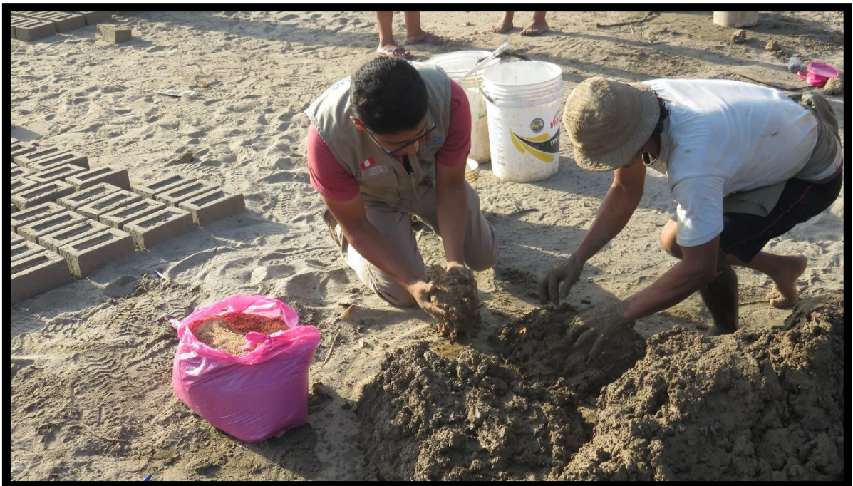
FOTO N° 16: VERIFICANDO QUE LA CONSISTENCIA DE LA MEZCLA NO CUMPLE CON LAS PROPORCIONES ADECUADAS, YA QUE NO ÑE ADICIDIONO LA ARENA CORRESPONDIENTE.
