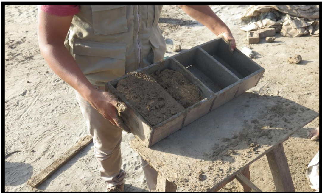
FOTO N° 18: DEAPUES DE ROSEAR ARENA FINA COBRE LAS PAREDES DEL MOLDE, SE PROCEDE AL LLENADO DE LA MEZCLA PREPARADA.
