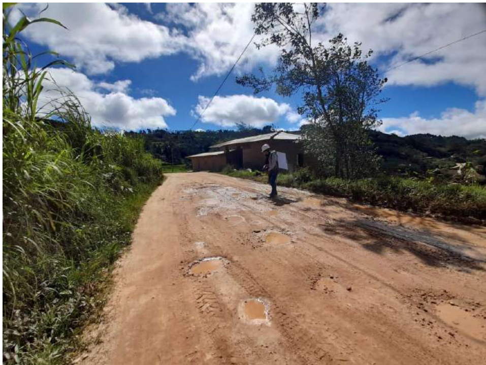
Figura N°1: Baches debido a las excesivas lluvias de la zona. Fuente: Fotos tomadas por los tesistas.
