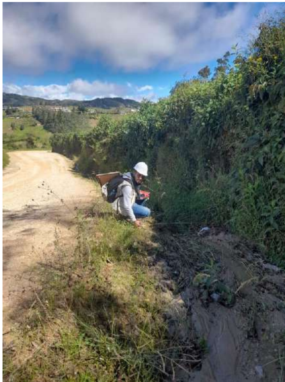
Figura 3: Presencia de material de derrumbe, que se debe retirar de las cunetas. Lo comúnmente llamado limpieza de terreno antes de la ejecución.
