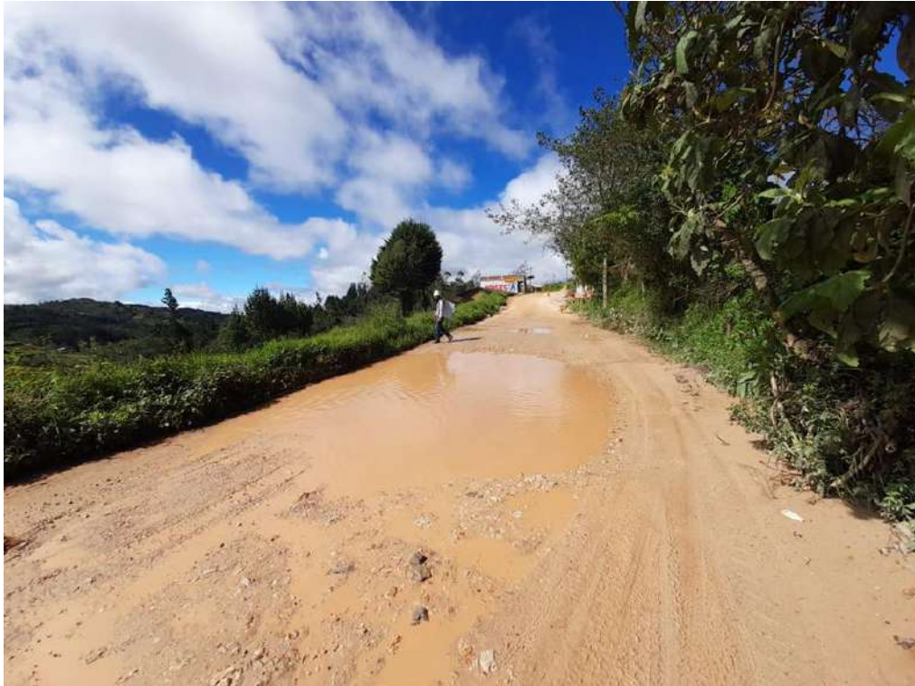
Figura 9: Consecuencia de las fuertes lluvias de la zona.
