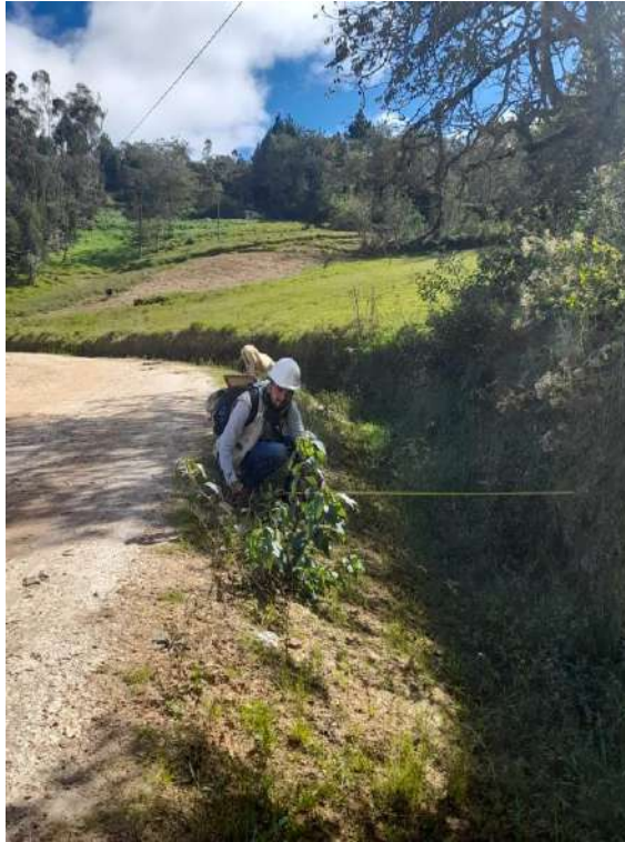
Figura 2: Evidencia de presencia de arbustos en las cunetas sin revestir.
