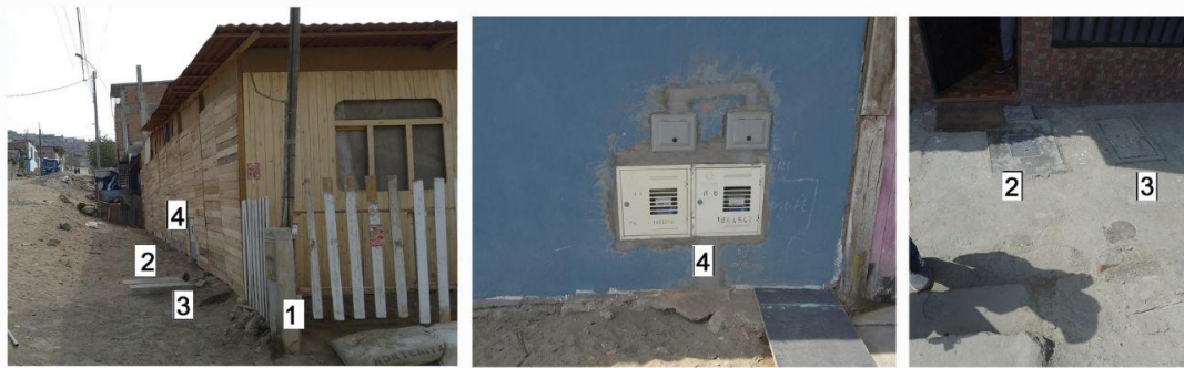
AÑO: 2022 1. Servicio de energía eléctrica (Enel) 3. Servicio de alcantarillado (Sedapal) 2. Servicio de agua potable (Sedapal) 4. Servicio de gas natural (Cálida)
