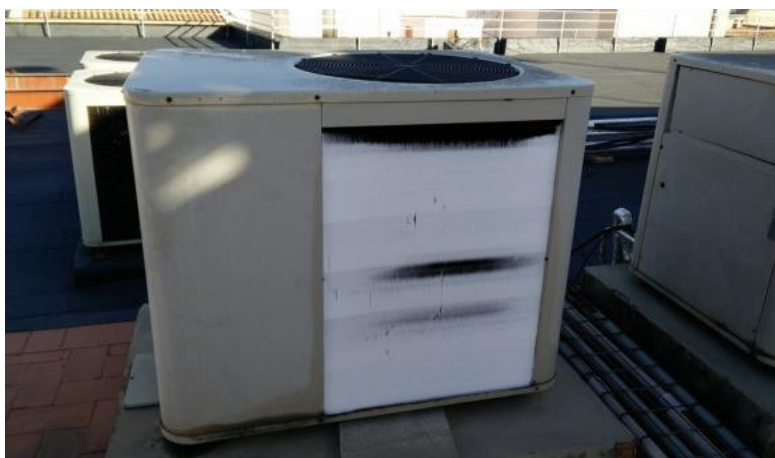
Figura N° 04: Equipo de aire acondicionado
