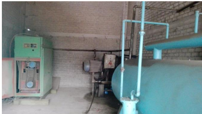
Sala de compresora con tanque acumulador de aire comprimido
