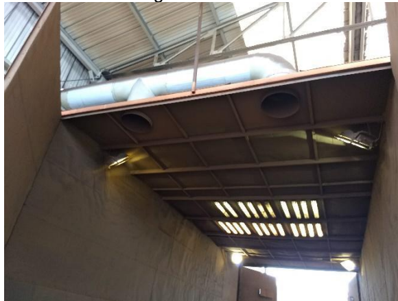
Toma aire contaminado con polvos con ducto de aspiración
