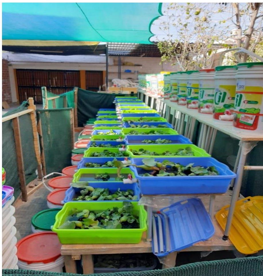
Figura 9. Instalación del sistema de tratamiento mixto de aguas residuales de curtiembre.
