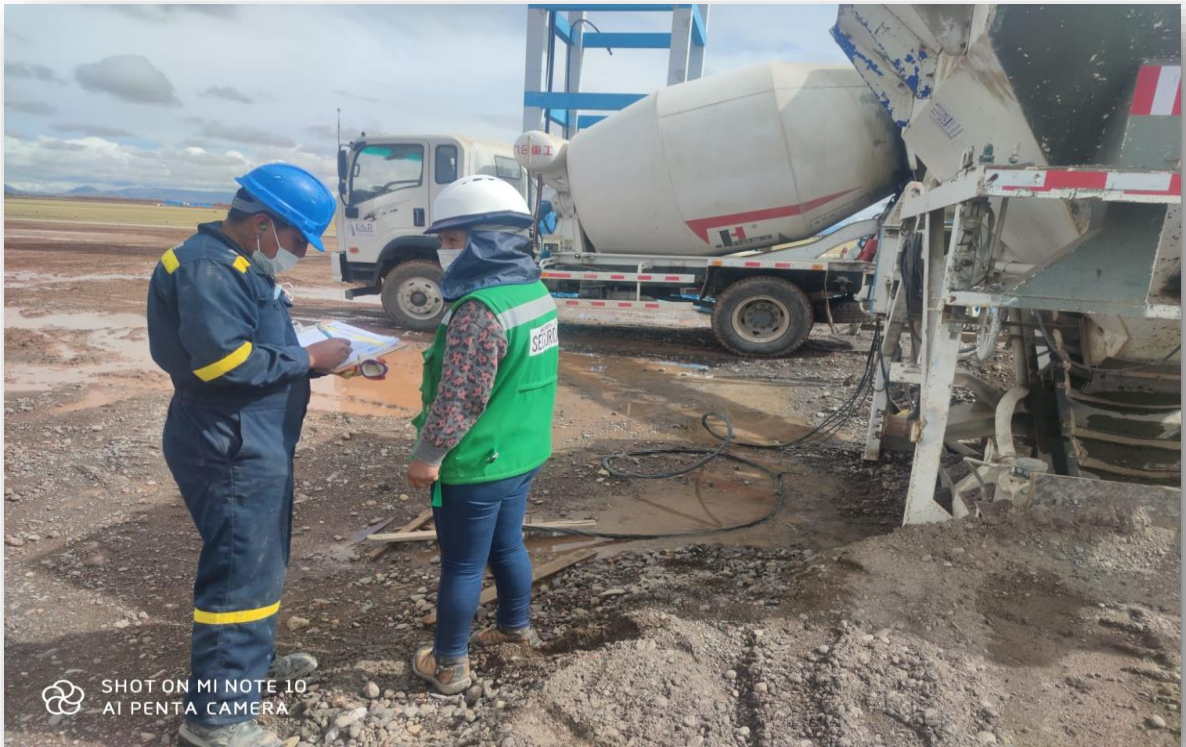
Fotografía 15: Inspección y llenado de CHECK LIST. En mixer, en el tramo A de la UNAJ
