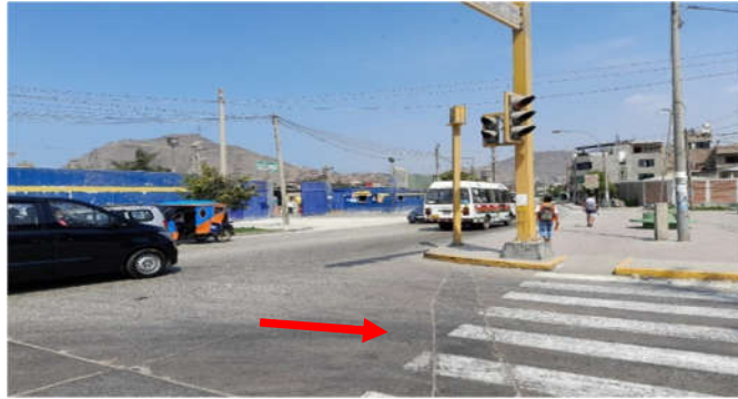
Figura 42. En este tramo se pudo apreciar la presencia de grietas y fisuras transversales
