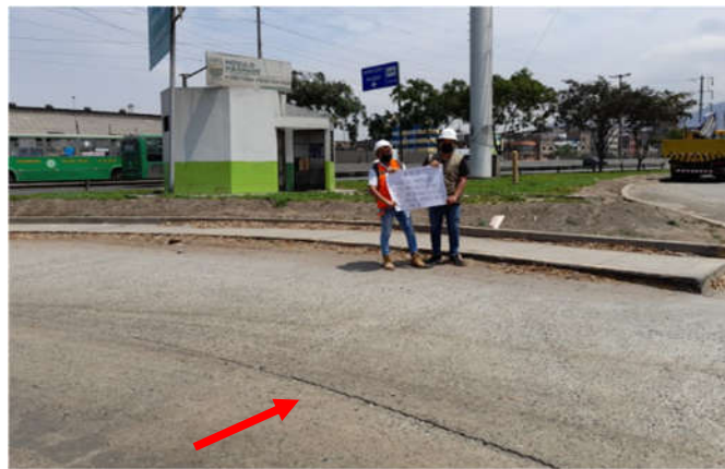
Figura 43. En este tramo se pudo apreciar la presencia de grietas y fisuras longitudinales
