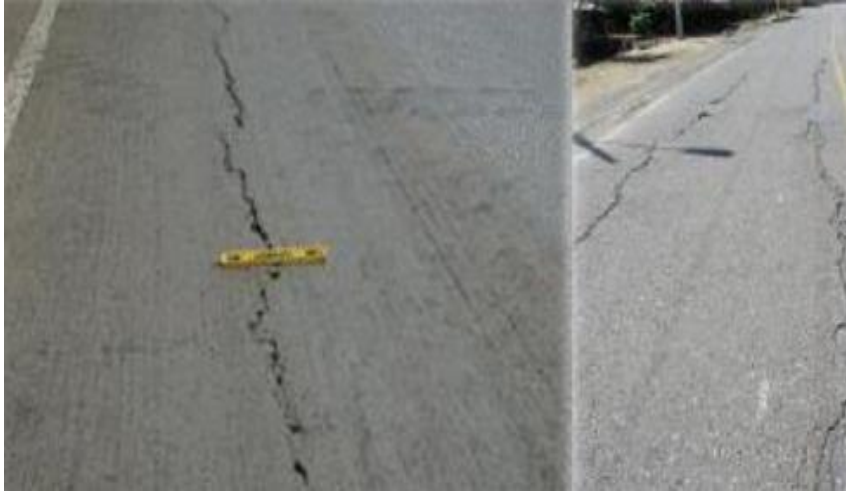
Figura 5. Fisuras longitudinales por fatiga. Fuente: Instituto Nacional de vías (2008).
