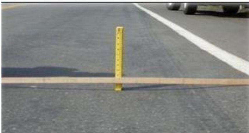
Figura 2. Deterioro por ahuellamiento.
