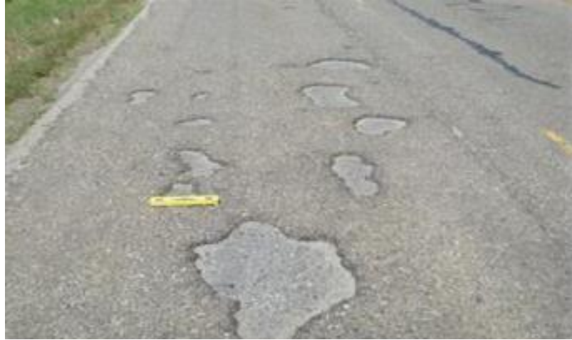
Figura 16. Descascaramiento. Fuente: Instituto Nacional de vías (2008).
