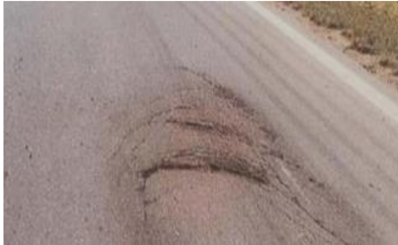
Figura 10. Fisuras parabólicas. Fuente: Instituto Nacional de vías (2008).
