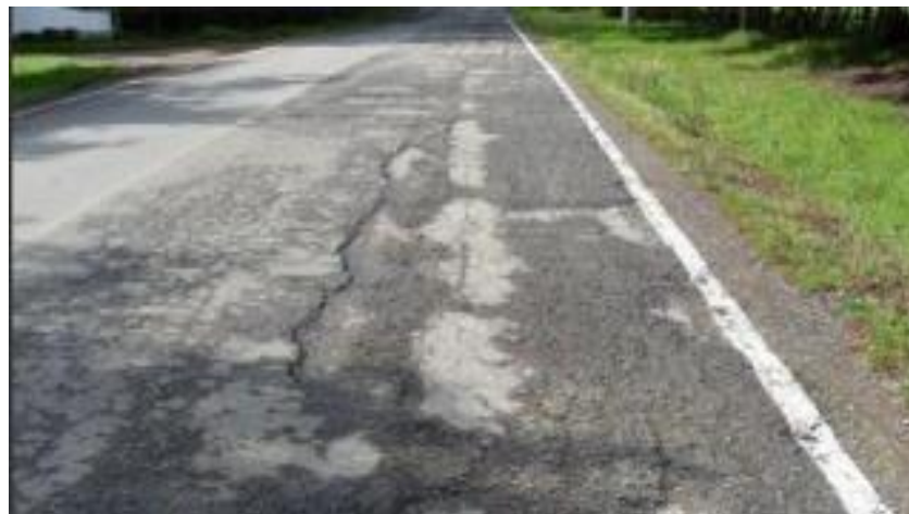
Figura 15. Pérdida de agregados.
