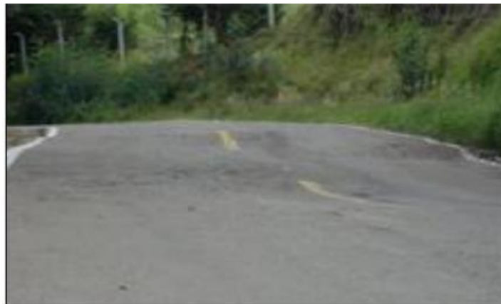
Figura 4. Depresiones o hundimientos transversales Fuente: Instituto Nacional de vías (2008).
