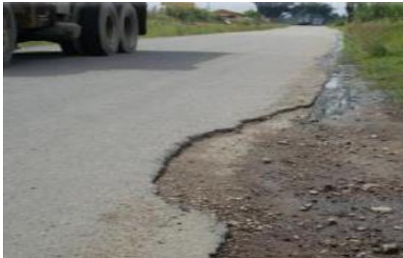
Figura 21. Desintegración de los bordes del pavimento. Fuente: Instituto Nacional de vías (2008).
