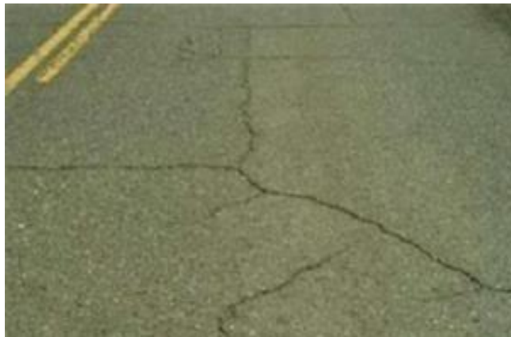
Figura 9. Fisura de contracción térmica.
