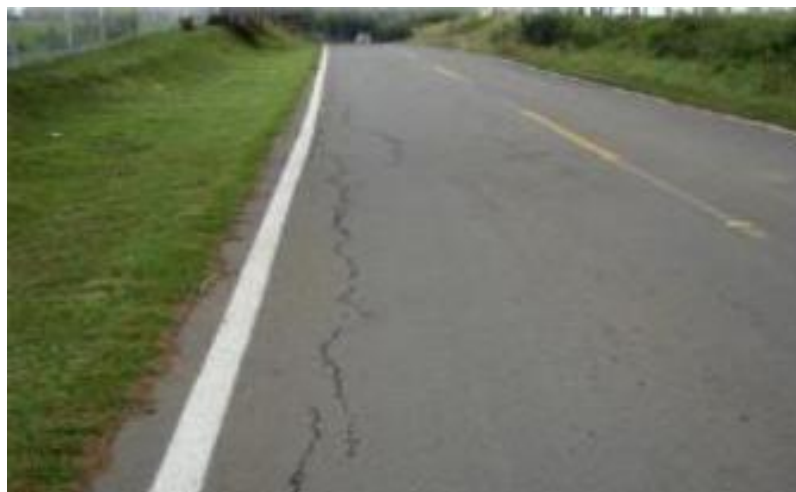
Figura 11. Fisuras de borde. Fuente: Instituto Nacional de vías (2008).
