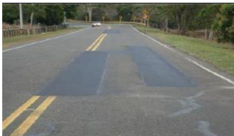
Figura 7. Deterioro por parcheos y bacheos. Fuente: Instituto Nacional de vías (2008).
