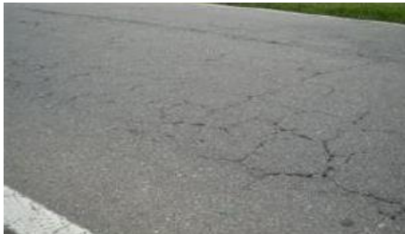
Figura 6. Deterioro por fisuras piel de cocodrilo. Fuente: Instituto Nacional de vías (2008).
