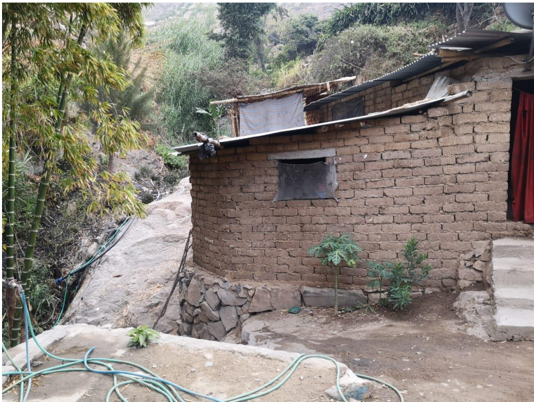
IMAGEN N°8: No existe conexiones domiciliarias adecuadas para las viviendas
