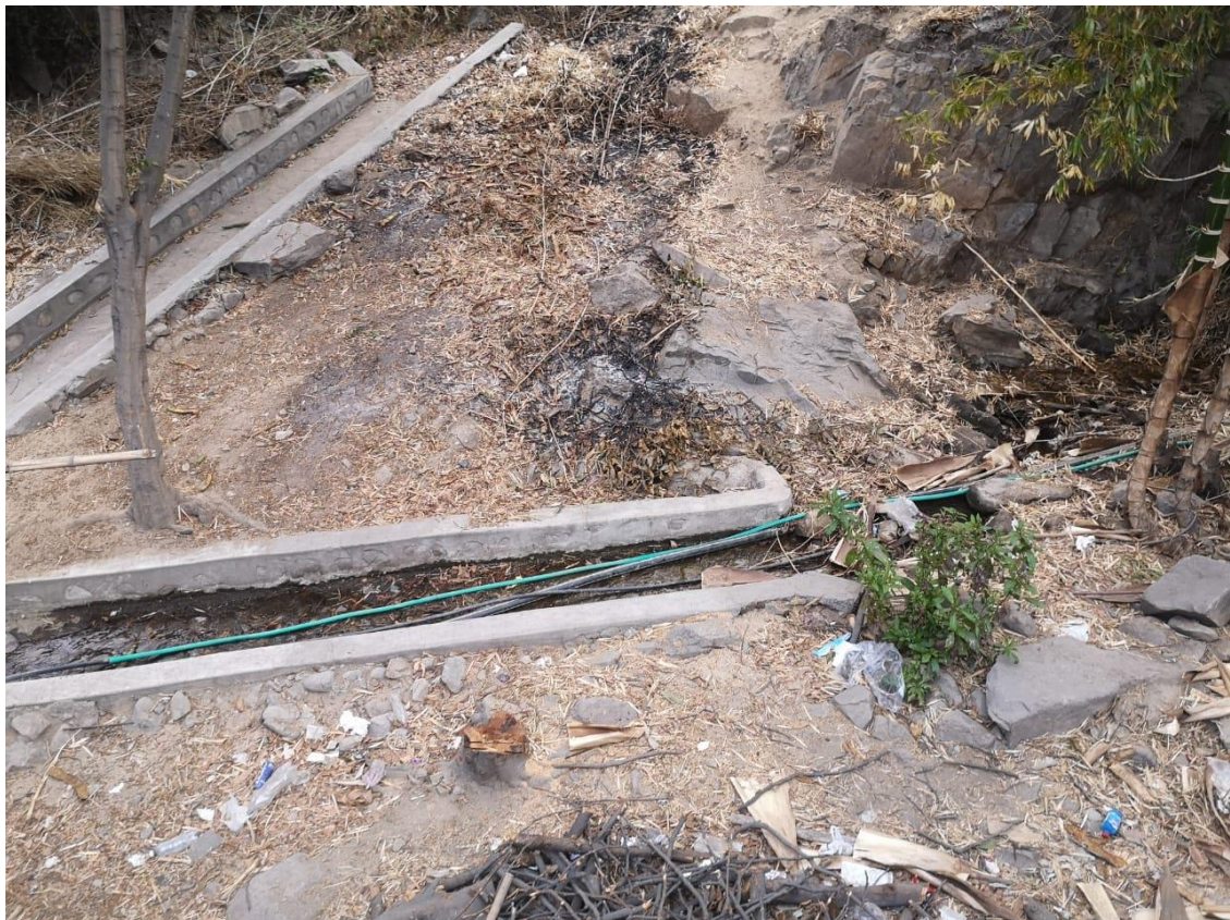
IMAGEN N°4: Líneas de distribución de agua potable en estado deplorable.
