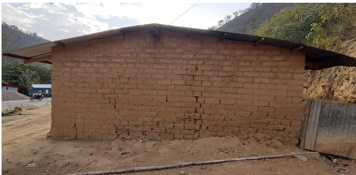
Figura 1. Vista y demostración con problemas de agrietamiento en viviendas.
