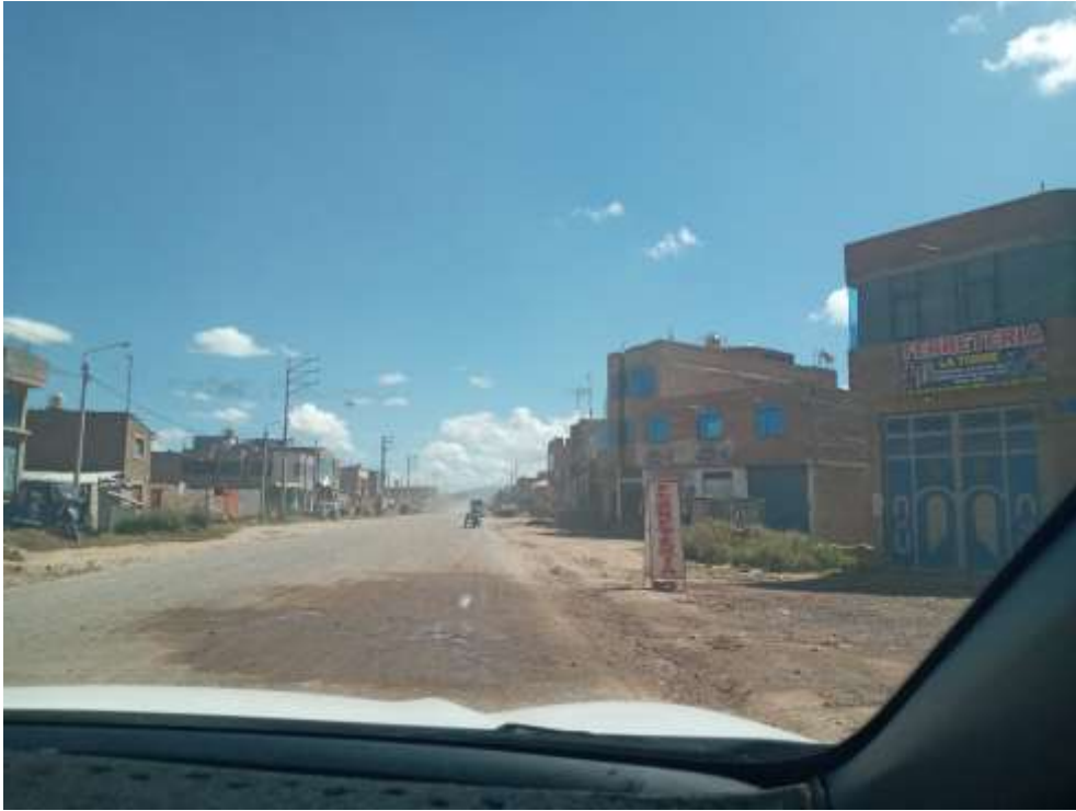
Fotografía 1. Estado actual de la carretera Juliaca - Lampa
