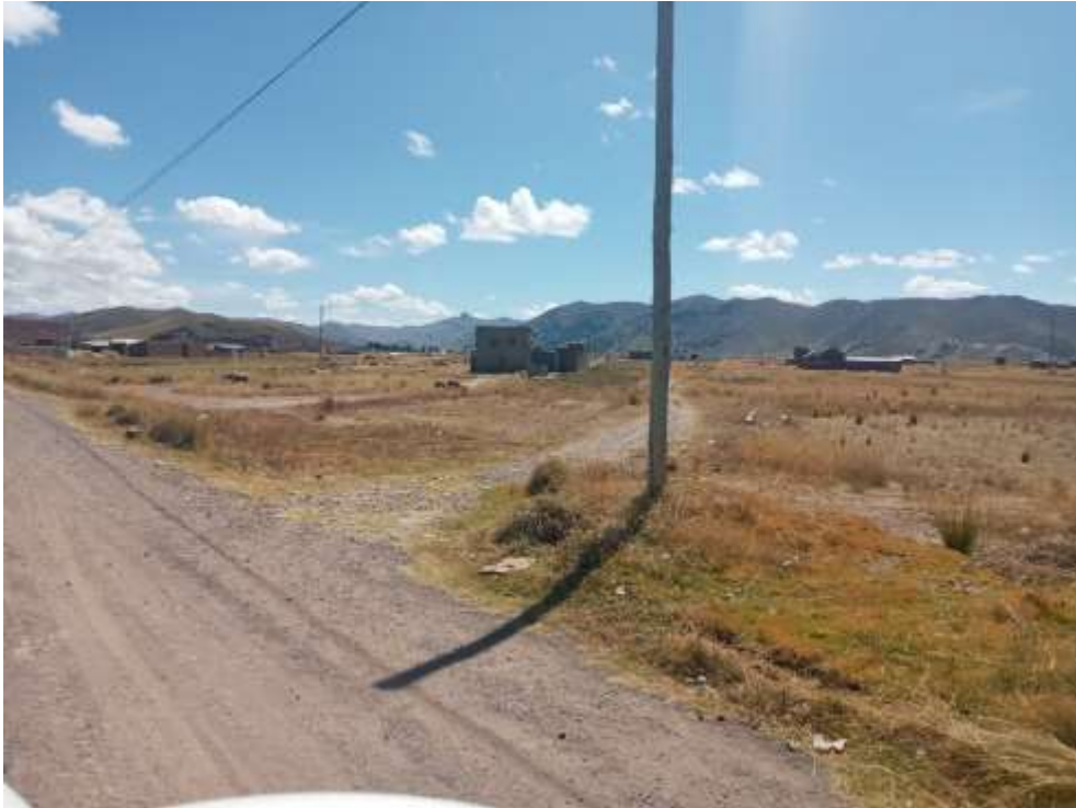
Fotografía 3. Carretera donde la capa asfáltica ya no se observa
