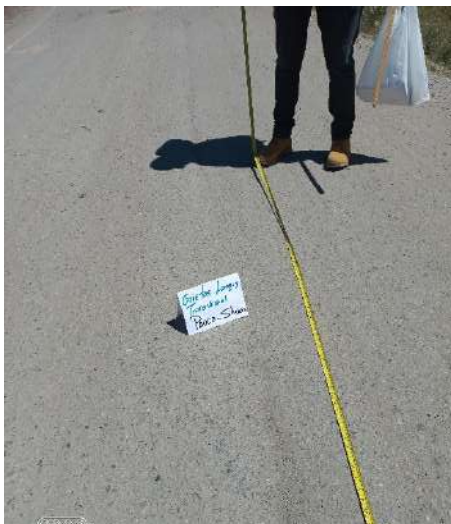
Foto 11: Grietas longitudinales Transversales
