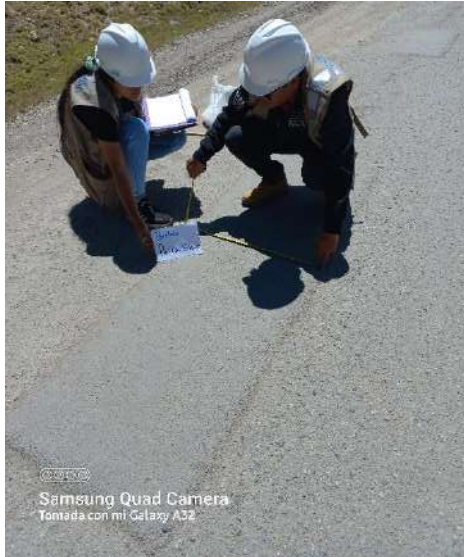
Foto 07: Toma de datos falla parcheo
