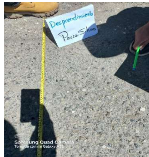
Foto 04: Toma de datos falla Desprendimiento
