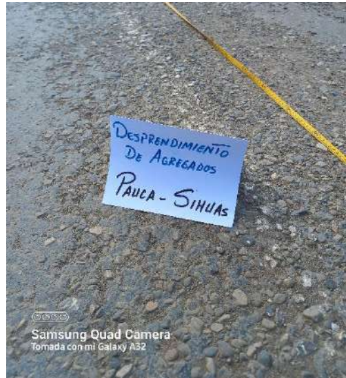
Foto 08: Desprendimiento de agregados
