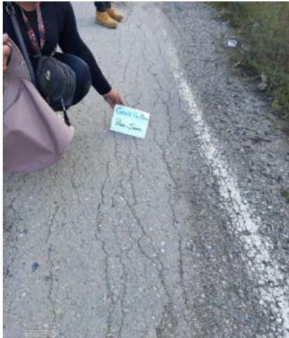
Foto 09: Grieta de Borde
