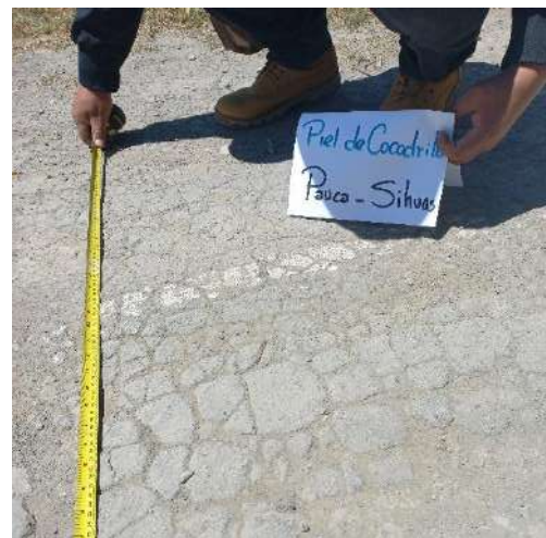
Foto 06: Toma de datos falla Piel de
