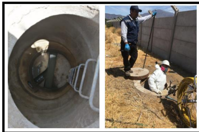
Figura 5: Cámara de Inspección
