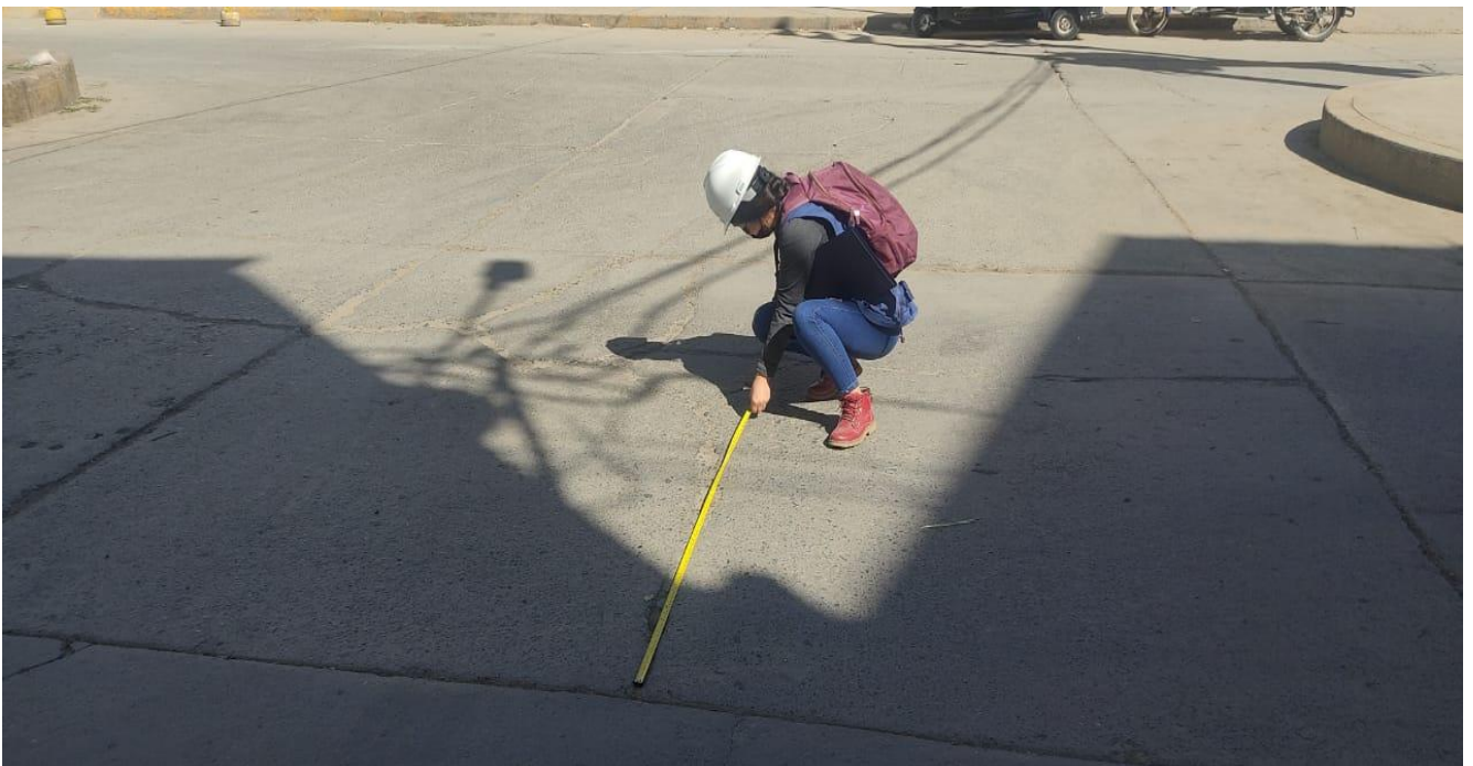
Figura 115. Evaluación de losa dividida con una severidad media (23M)
