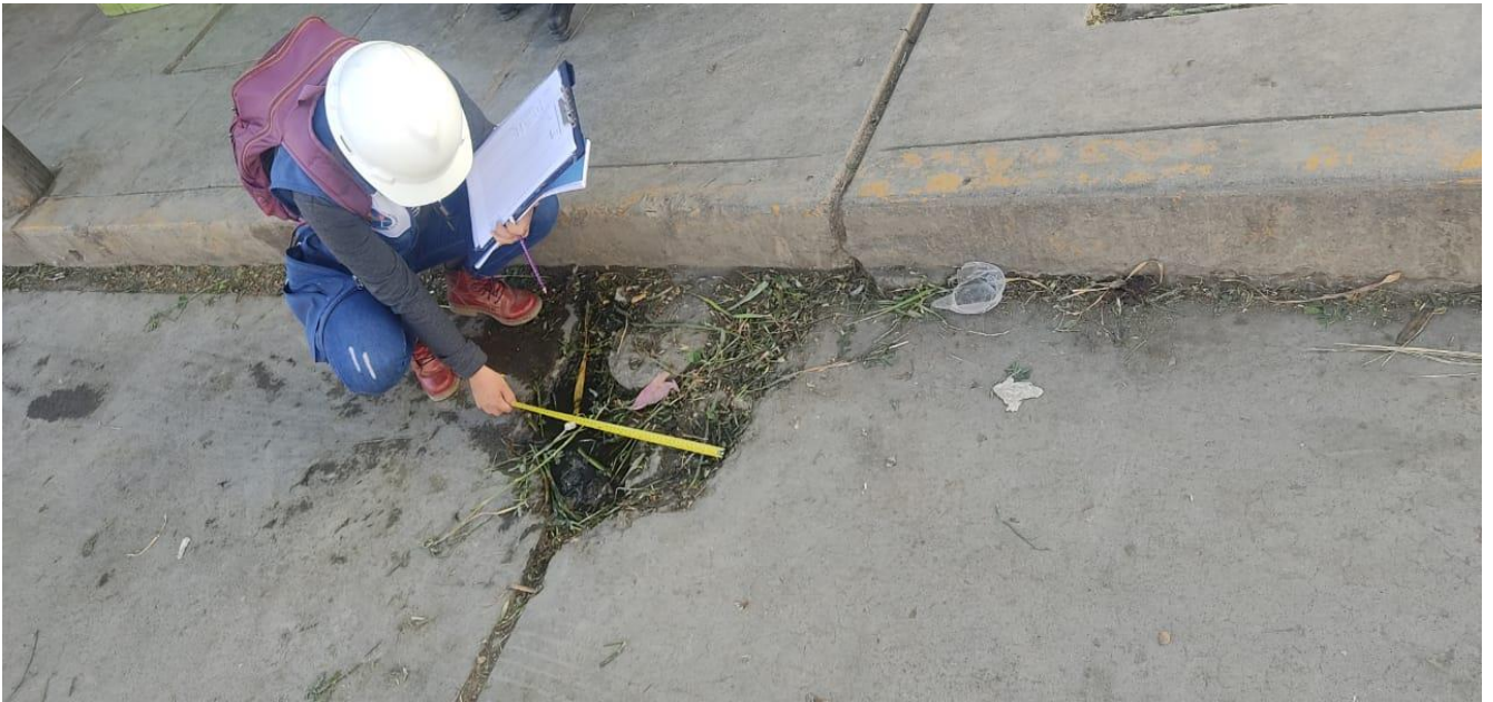
Figura 114. Evaluación de descascaramiento de juntas de severidad alta (38H)
