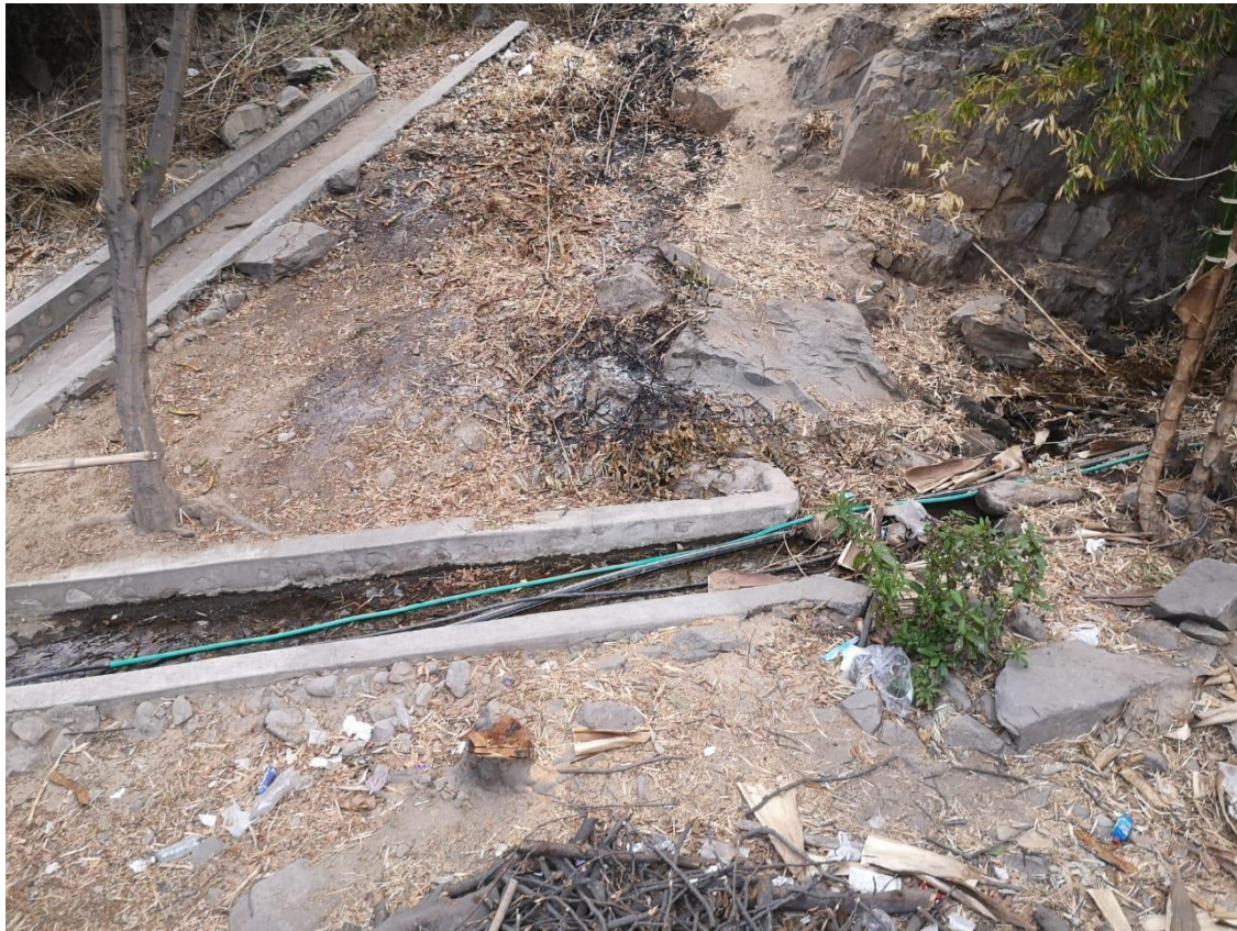
Líneas de distribución de agua potable en estado deplorable.
