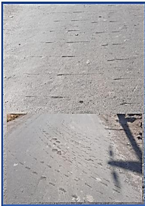
FOTOGRAFIA N° 7: MEDICIÓN DE LA FALLA AHUELLAMIENTO.
