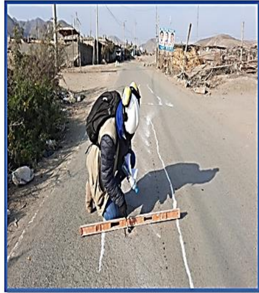
FOTOGRAFIA N° 22: SEÑALIZACIÓN DE LA FALLA GRIETAS LONGITUDINALES Y TRANSVERSALES.
