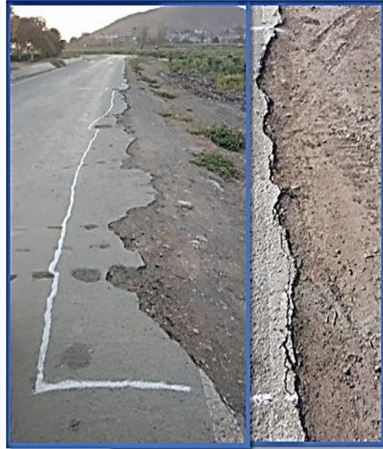
FOTOGRAFIA N° 6: SEÑALIZACIÓN DE LA FALLA GRIETAS DE BORDE.
