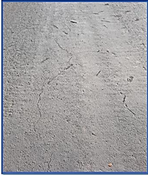
FOTOGRAFIA N° 21: FALLA GRIETAS LONGITUDINALES Y TRANSVERSALES.
