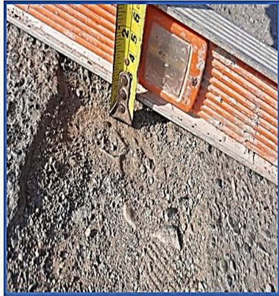
FOTOGRAFIA N° 20: MEDICION DE LA FALLA GRIETAS DE BORDE Y PIEL DE COCODRILO.
