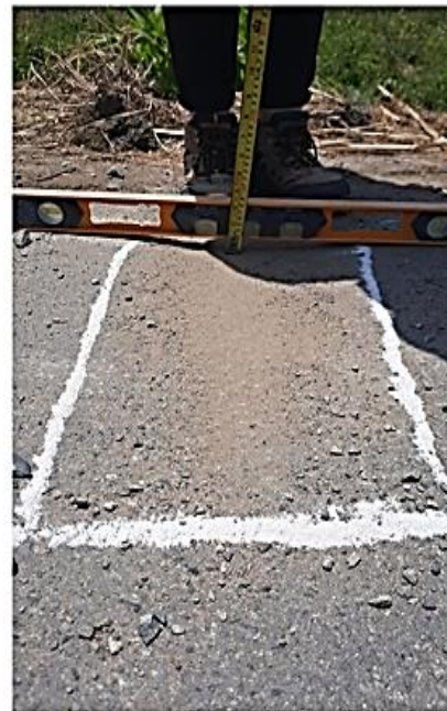
FOTOGRAFIA N° 24: SEÑALIZACIÓN DE LA FALLA PULIMIENTO DE AGREGADOS.
