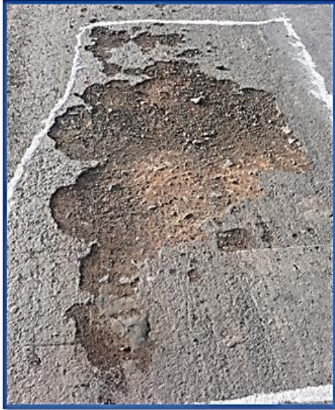
FOTOGRAFIA N° 13: MEDICIÓN DE LA FALLA HUECOS - OJOS DE PESCADO.
