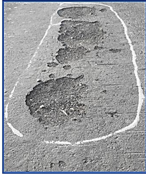
FOTOGRAFIA N° 14: SEÑALIZACIÓN DE LA FALLA HUECOS - OJOS DE PESCADO.
