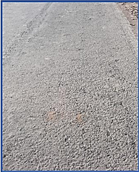
FOTOGRAFIA N° 15: MEDICIÓN DE LA FALLA PULIMIENTO DE AGREGADOS.
