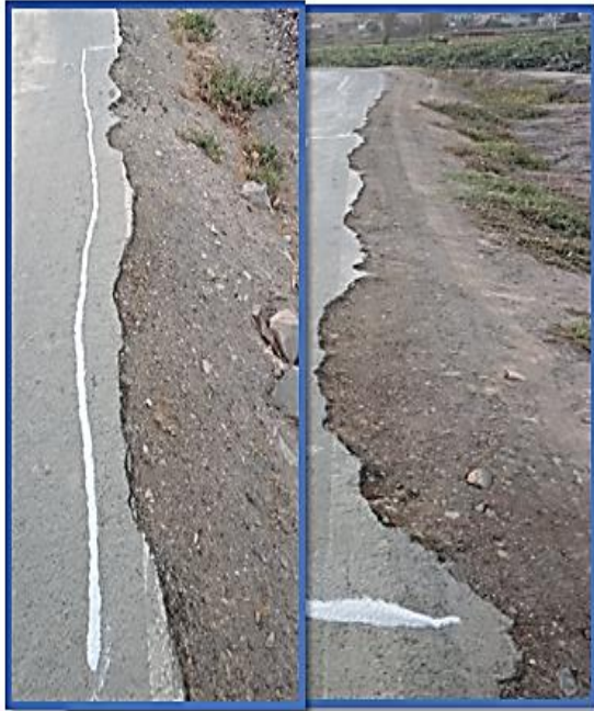
FOTOGRAFIA N° 5: MEDICIÓN DE LA FALLA GRIETAS DE BORDE.
