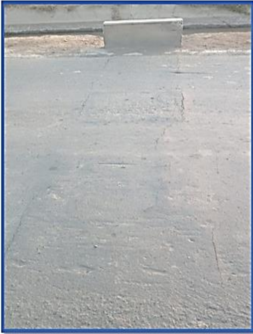
FOTOGRAFIA N° 17: MEDICIÓN DE LA FALLA PARCHEO.
