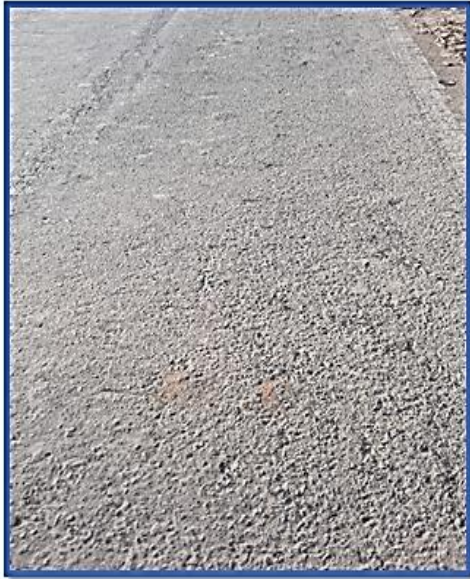
FOTOGRAFIA N° 9: MEDICIÓN DE LA FALLA PULIMIENTO DE AGREGADOS.
