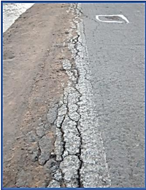
FOTOGRAFIA N° 19: FALLA GRIETAS DE BORDE Y PIEL DE COCODRILO.
