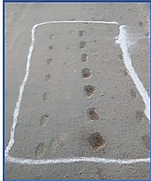
FOTOGRAFIA N° 10: SEÑALIZACIÓN DE LA FALLA AHUELLAMIENTO
