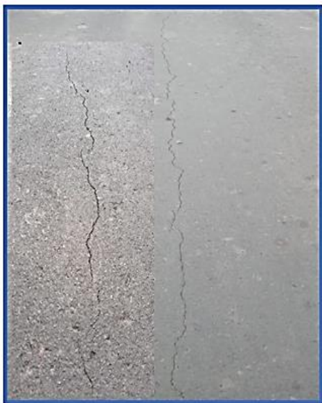
FOTOGRAFIA N° 11: MEDICIÓN DE LA FALLA GRIETAS LONGITUDINALES.
