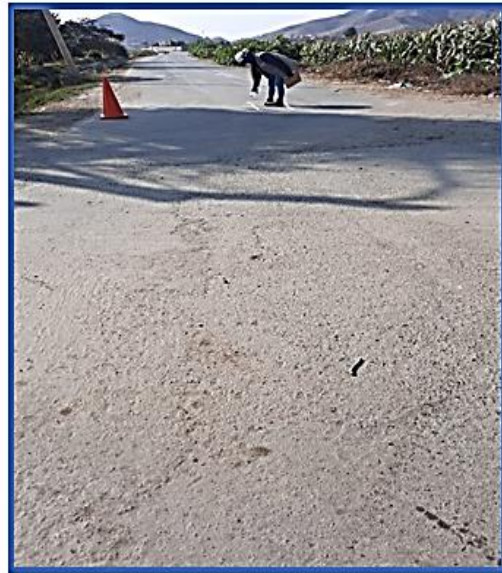
FOTOGRAFIA N° 16: SEÑALIZACIÓN DE LA FALLA PULIMIENTO DE AGREGADOS Y FISURAS LONGITUDINALES.
