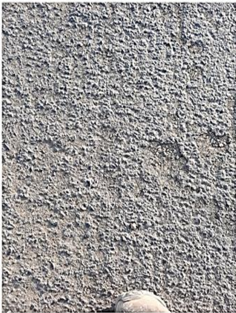
FOTOGRAFIA N° 23: FALLA PULIMIENTO DE AGREGADOS.
