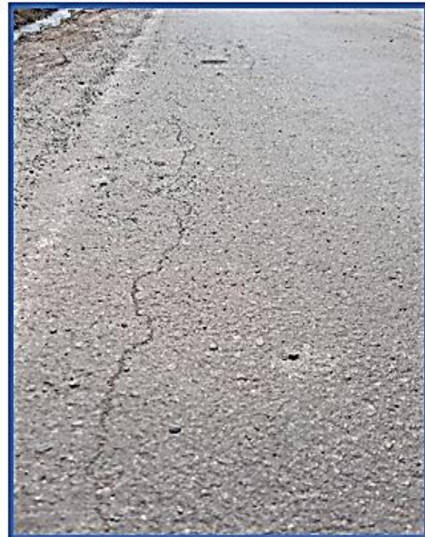
FOTOGRAFIA N° 12: SEÑALIZACIÓN DE LA FALLA GRIETAS LONGITUDINALES.
