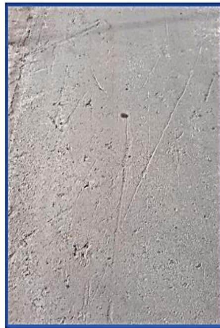
FOTOGRAFIA N° 8: SEÑALIZACIÓN DE LA FALLA AHUELLAMIENTO.
