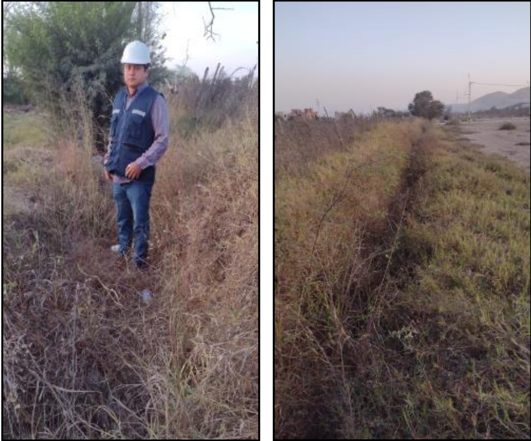
Figura.40 Se identificó la vegetación excesiva en el canal de estudio.
