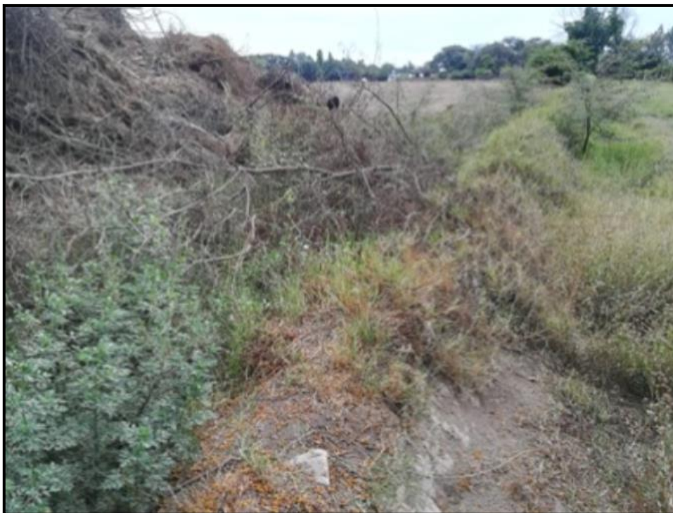
Figura.29 Se aprecia vegetación excesiva en la estructura del canal.
