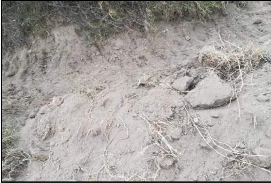
Figura.30 Colmatación existente dentro del canal.
