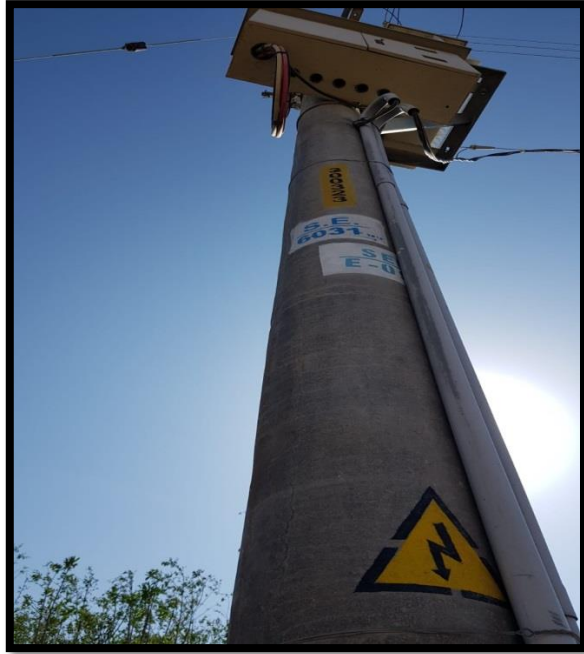
Figura 43: Se muestra el código de la subestación que se proyectó para la alimentación de la asociación de vivienda los próceres de Torata.
