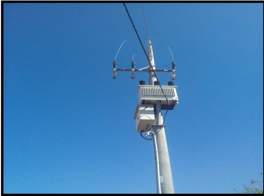
Figura 27: Se muestra la subestación donde se proyectó la alimentación de energía eléctrica de la asociación de vivienda los próceres de Torata.
