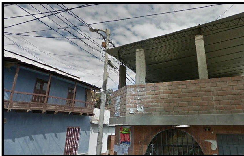
Figura 21: Se muestra un acercamiento con el incumplimiento de las distancias mínimas de seguridad. Fuente: Elaboración propia.
