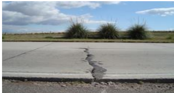
Figura 2: Falla causada por pérdida de material en el apoyo de la calzada
