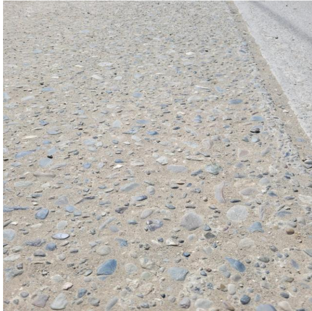
Figura 26: Exposición de los agregados en la superficie
