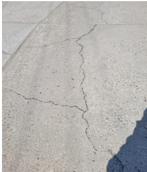
Figura 21: Fisuras en la losa
