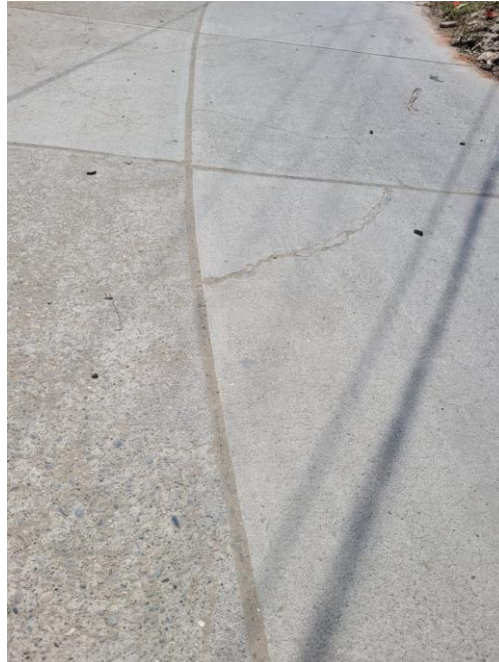
Figura 22: Falla en esquina
