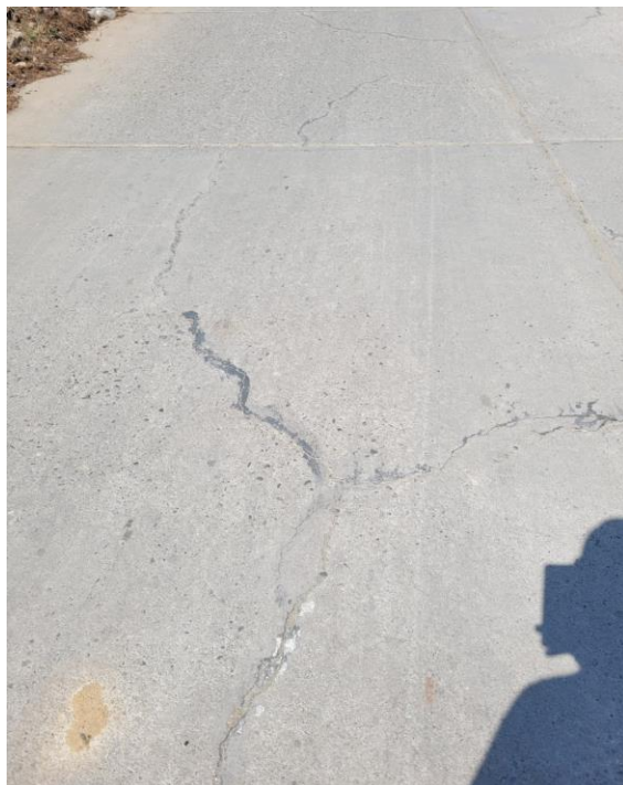
Figura 25: Grietas curadas en la losa
