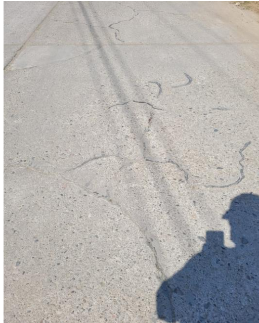
Figura 20: Fisuras en la losa
