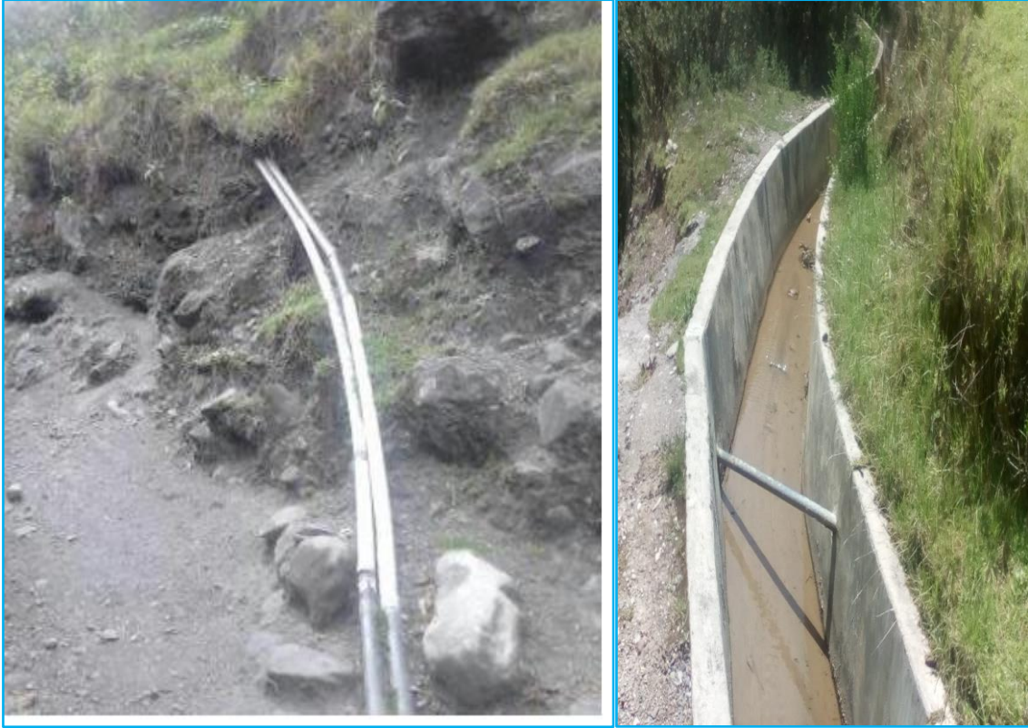
Foto N°03: Tuberías expuestas a menos de 0.35 m de la línea de conducción.
