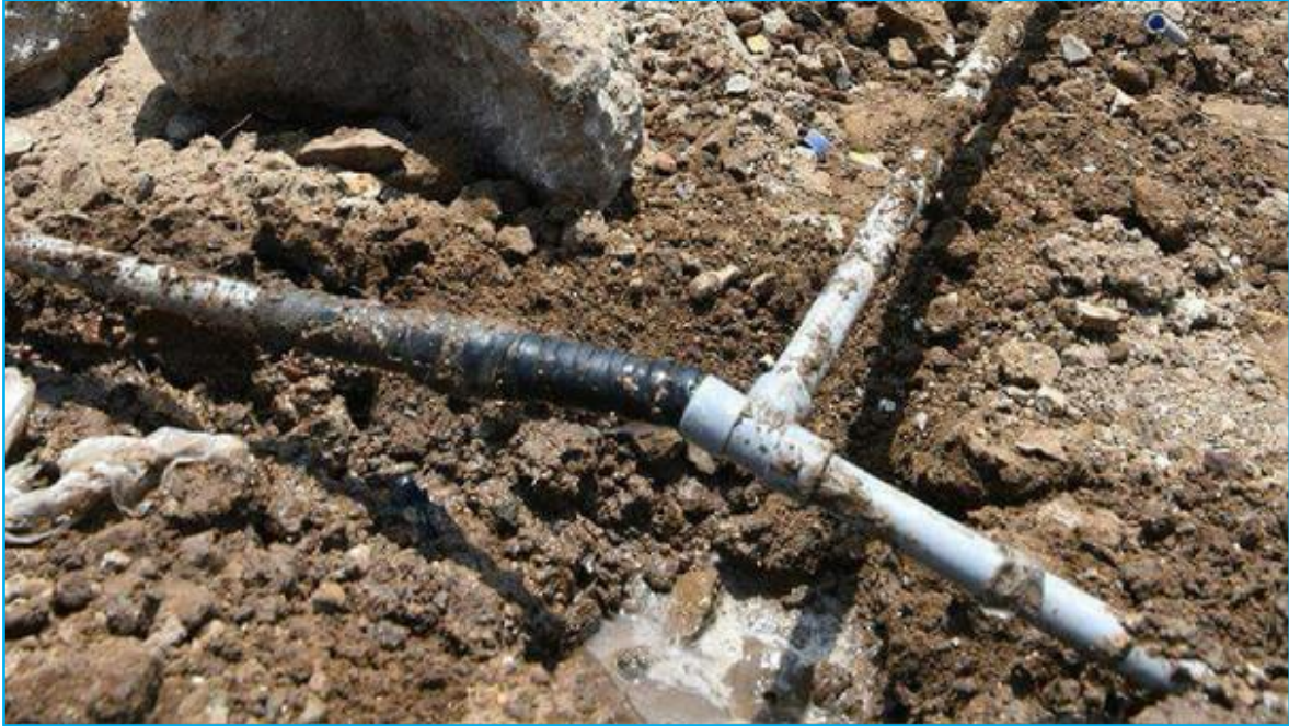
Foto N°07.conexiones domiciliarias en mal estado
