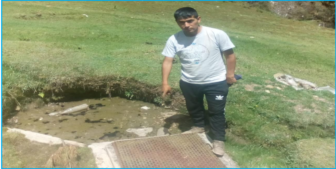
Foto N°05. Camara de ronpe presion en mal estado
