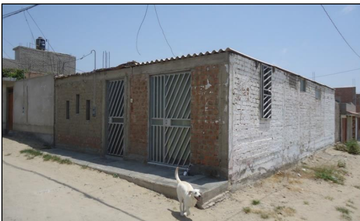
Foto N°02: se muestra en la figura una estructura encajonada, con los elementos estructurales a sin tarrajear, además tienen cobertura de materiales diferentes al concreto como esteras y eternit, incluso se nota parte del sobre cimiento.
