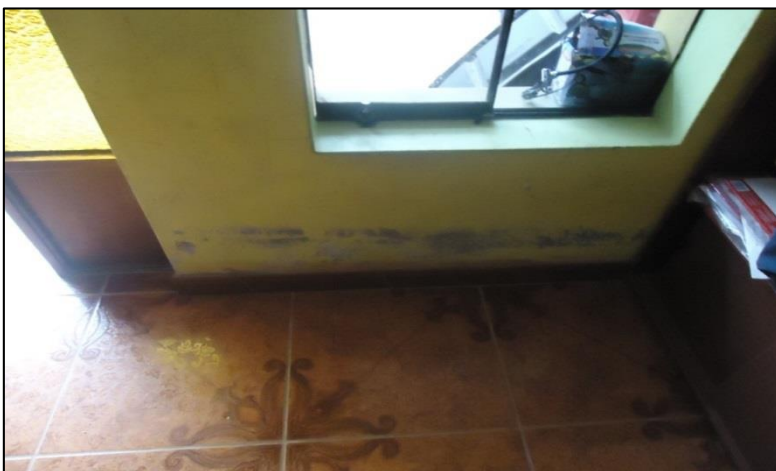
Foto N°01: Problemas de humedad en muros, como se puede notar el alfeizar de la ventana tiene una altura de 0.8 m.
