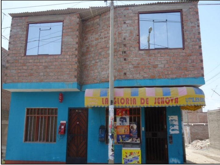
Foto N°10: Como se observa en la figura el segundo nivel tiene discontinuidad horizontal del muro, teniendo un muro diagonal que reduce la rigidez del volado, generando concentraciones esfuerzos y posteriormente fallas por torsión. Vulnerabilidad alta ítem 1.1
