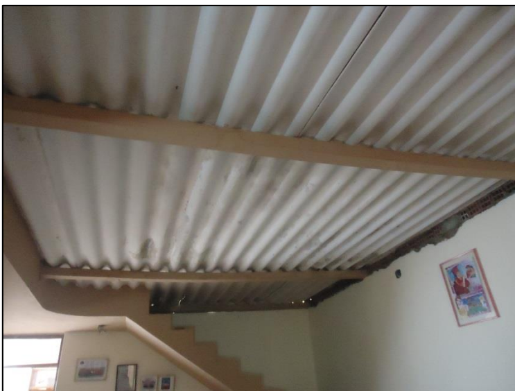
Foto N°06: se Observa en la imagen la cubierta es de ethernit de 8 mm. Con vigas de madera de 2"x2" y apoyados en el muro del lado derecho y sobre losa aligerada en el lado izquierdo dando, la luz de la viga es de 3.50 m. vulnerabilidad media ítem 3.3 y 3.6
