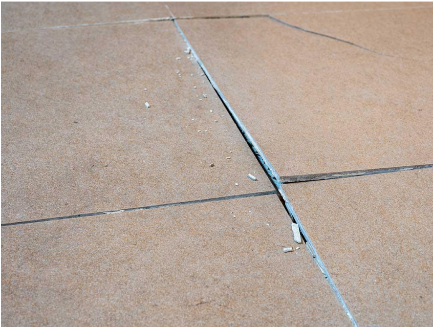
Figura 27: Piso del área de producción en malas condiciones Fuente: ELISE S.A.C.
