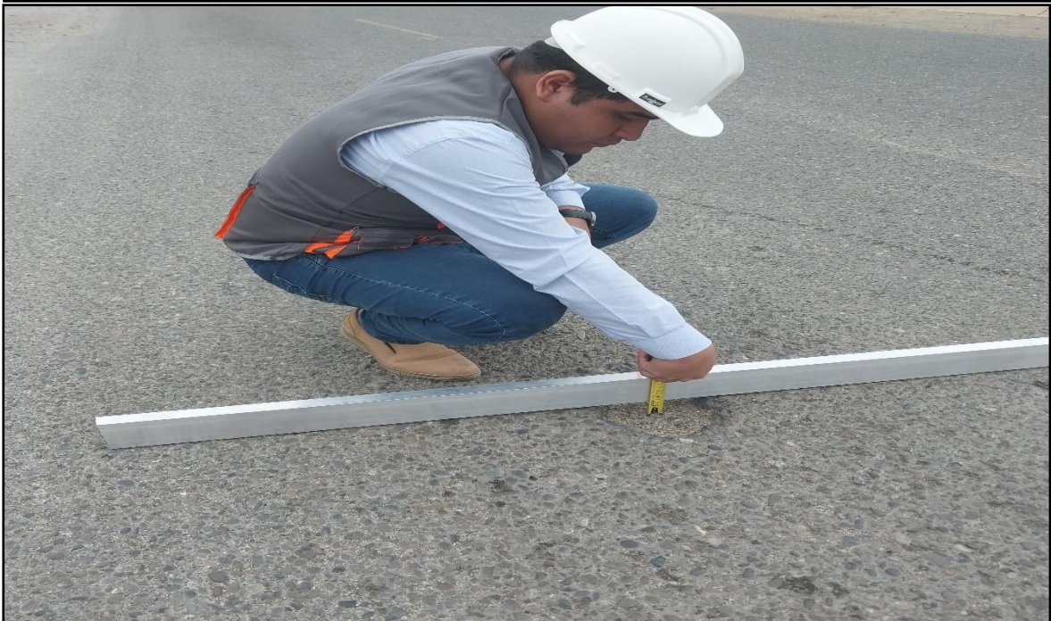
Panel fotográfico: Deterioros analizados Sección 23
