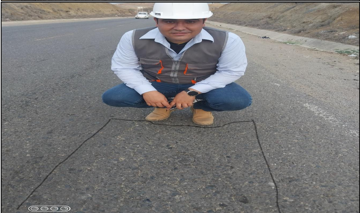
Panel fotográfico: Deterioros analizados Sección 1
