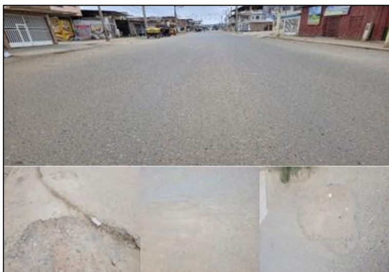
Figura 1- Tipos de deterioros existentes en la Av. Universitaria – Tumbes.
