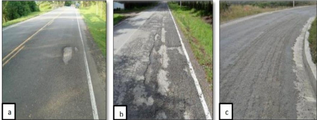
Figura 16: Perdida de agregados – Tipo B
