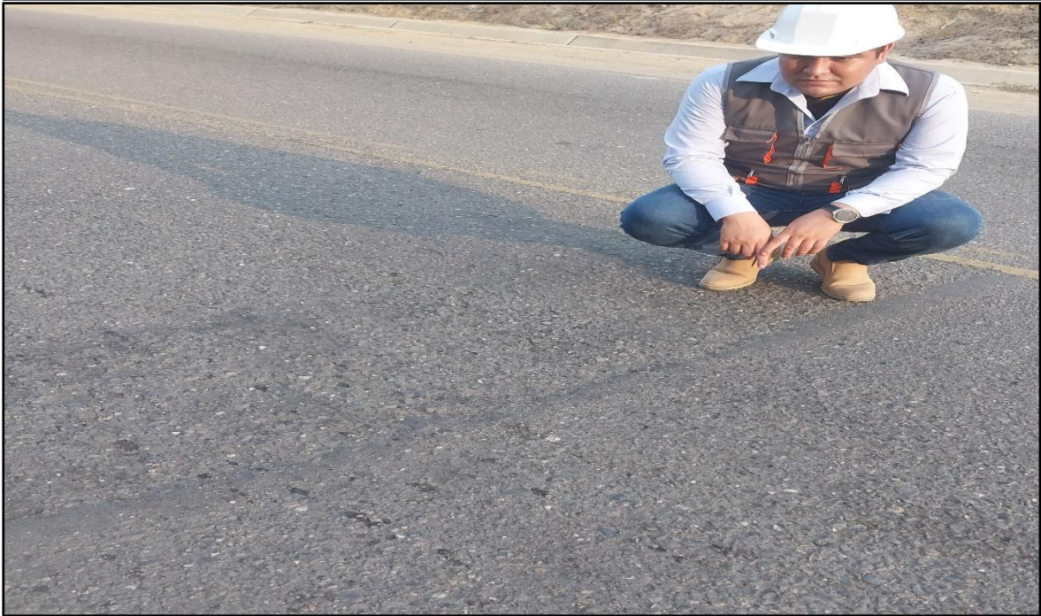
Panel fotográfico: Deterioros analizados Sección 24
