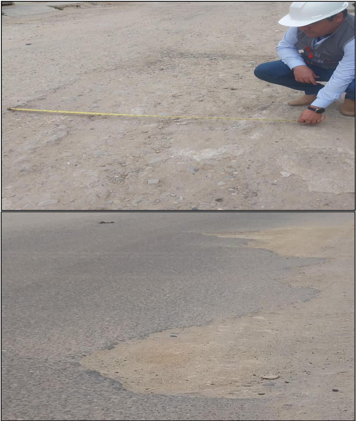
Panel fotográfico: Deterioros analizados Sección 21
