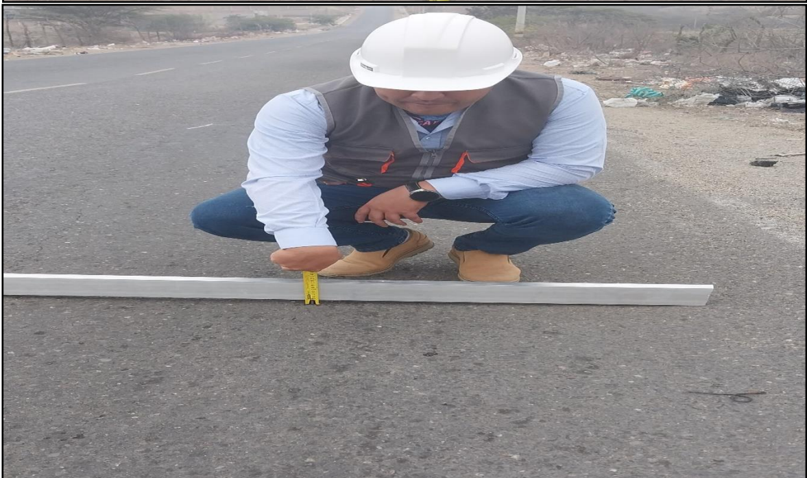
Panel fotográfico: Deterioros analizados Sección 16
