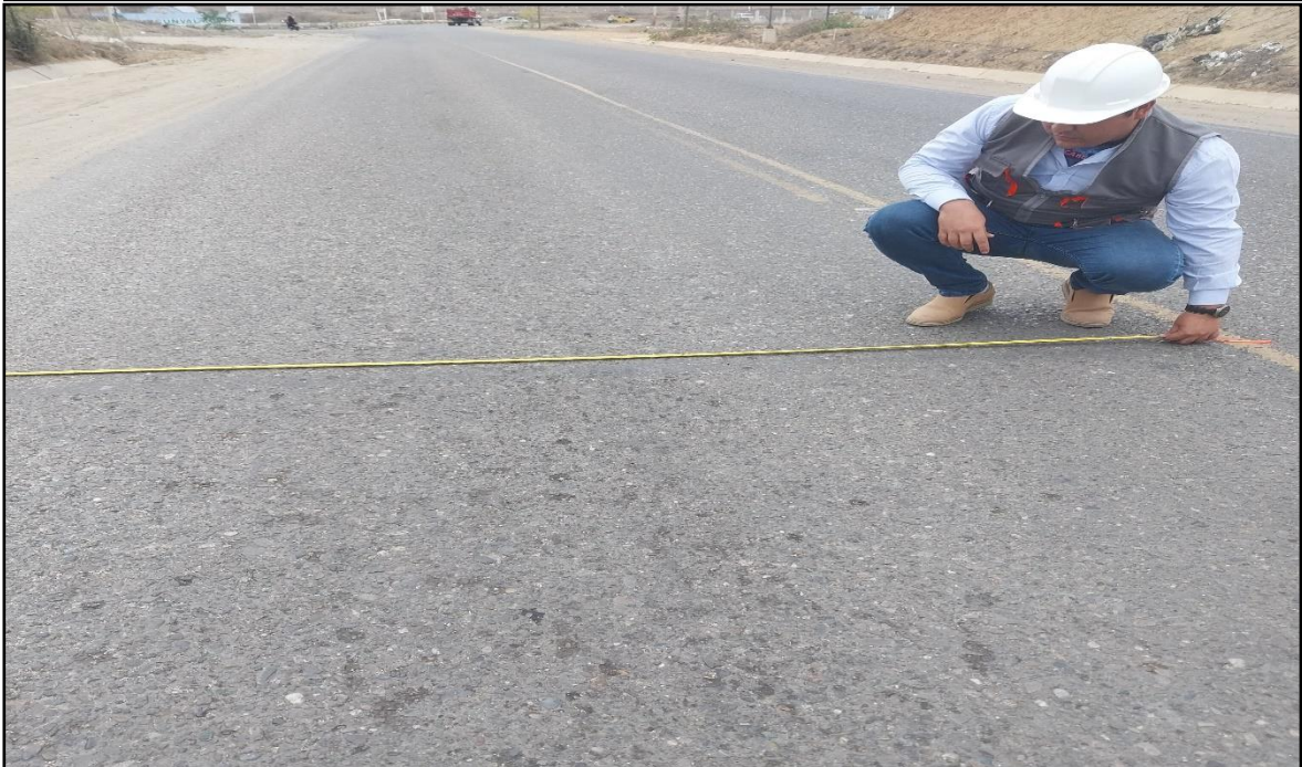
Panel fotográfico: Deterioros analizados Sección 4
