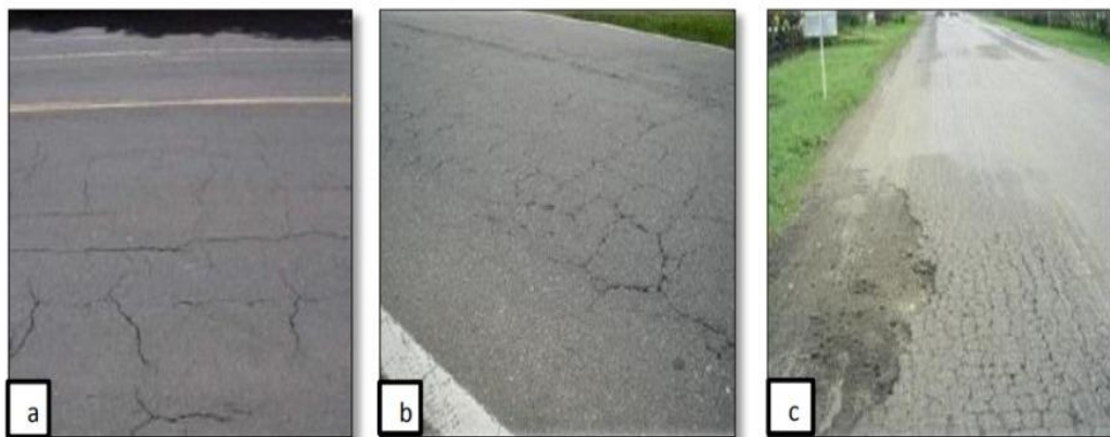
Figura 6: Fisuras piel de cocodrilo – Tipo A
