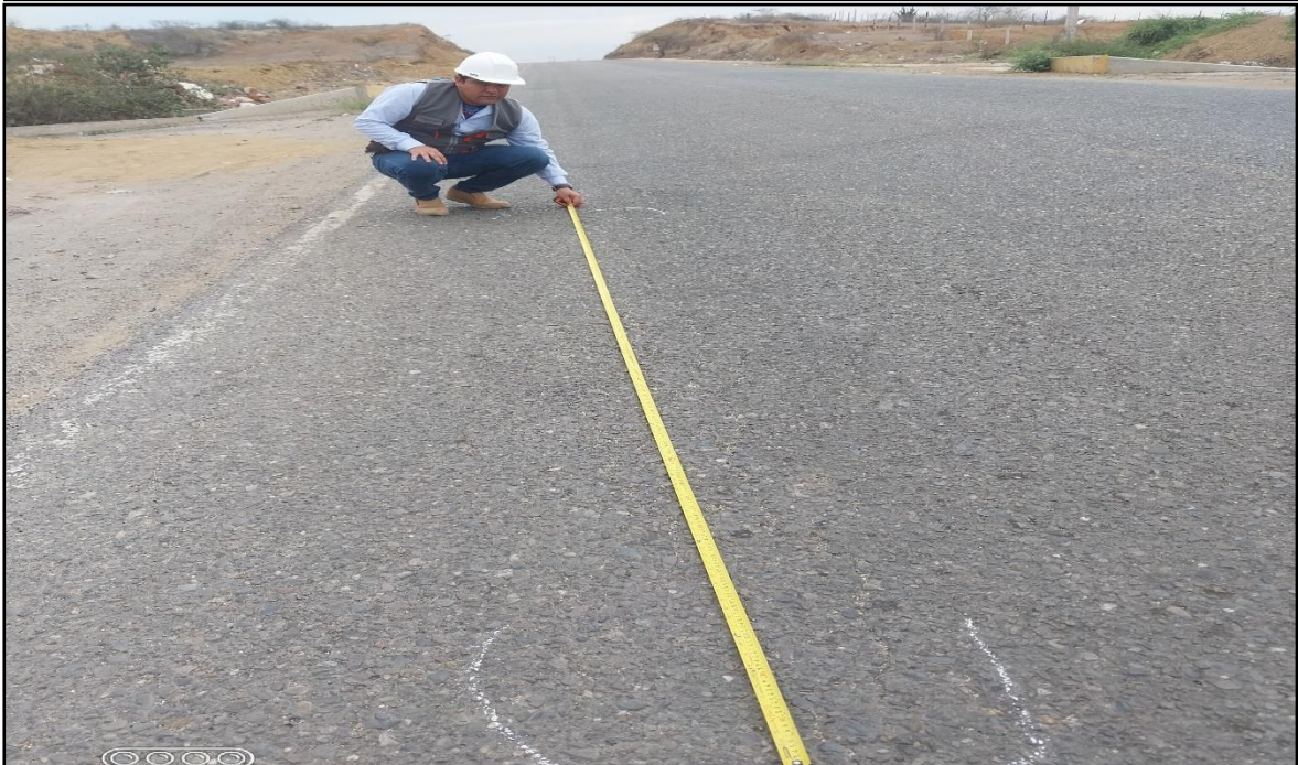
Panel fotográfico: Deterioros analizados Sección 19
