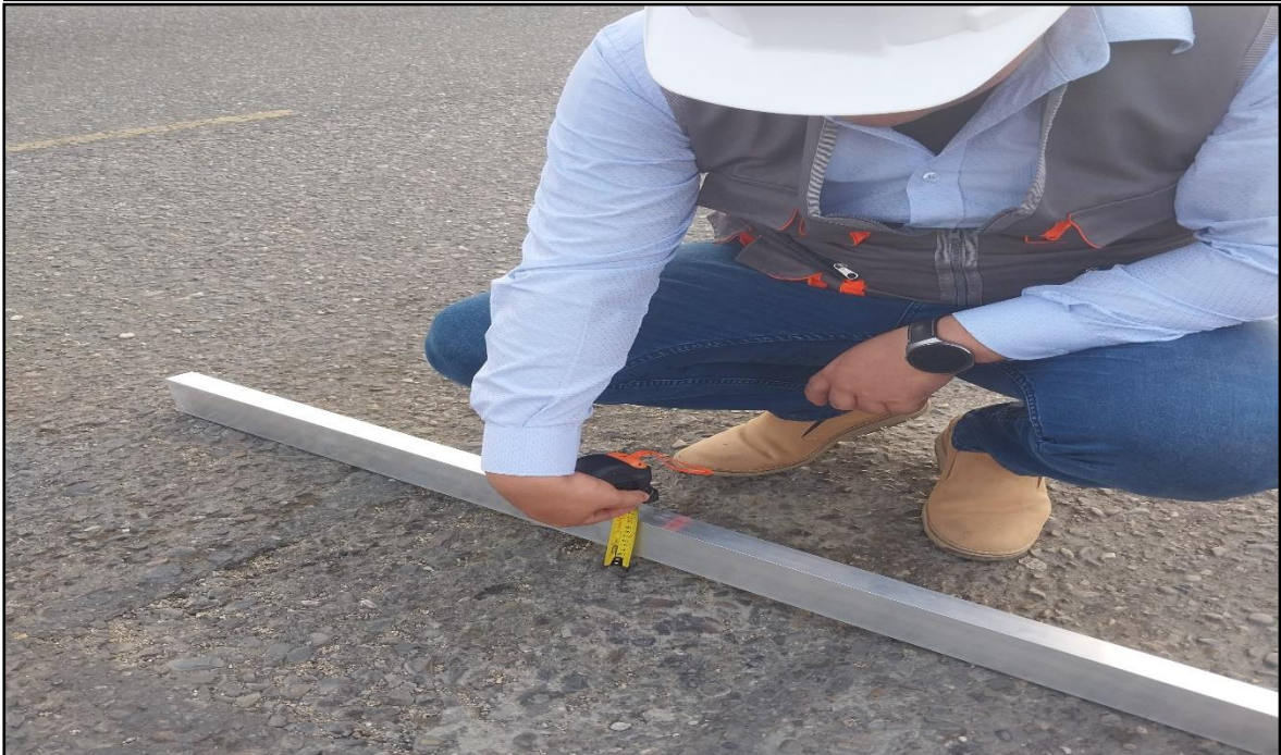
Panel fotográfico: Deterioros analizados Sección 7
