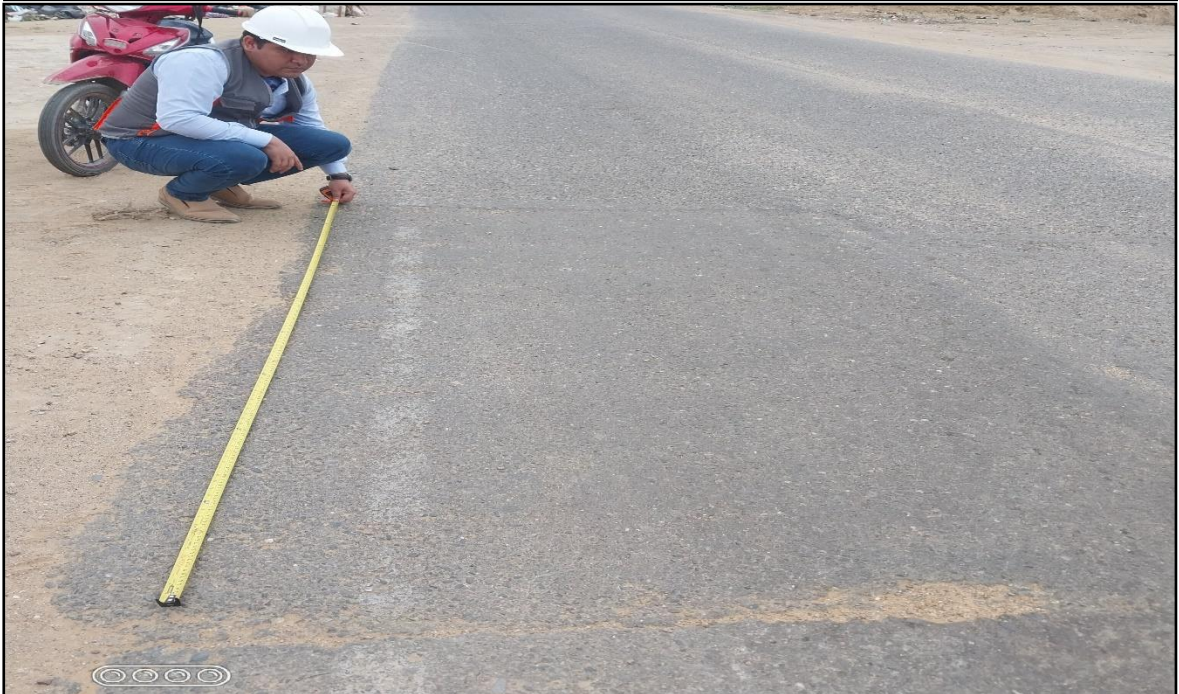
Panel fotográfico: Deterioros analizados Sección 14
