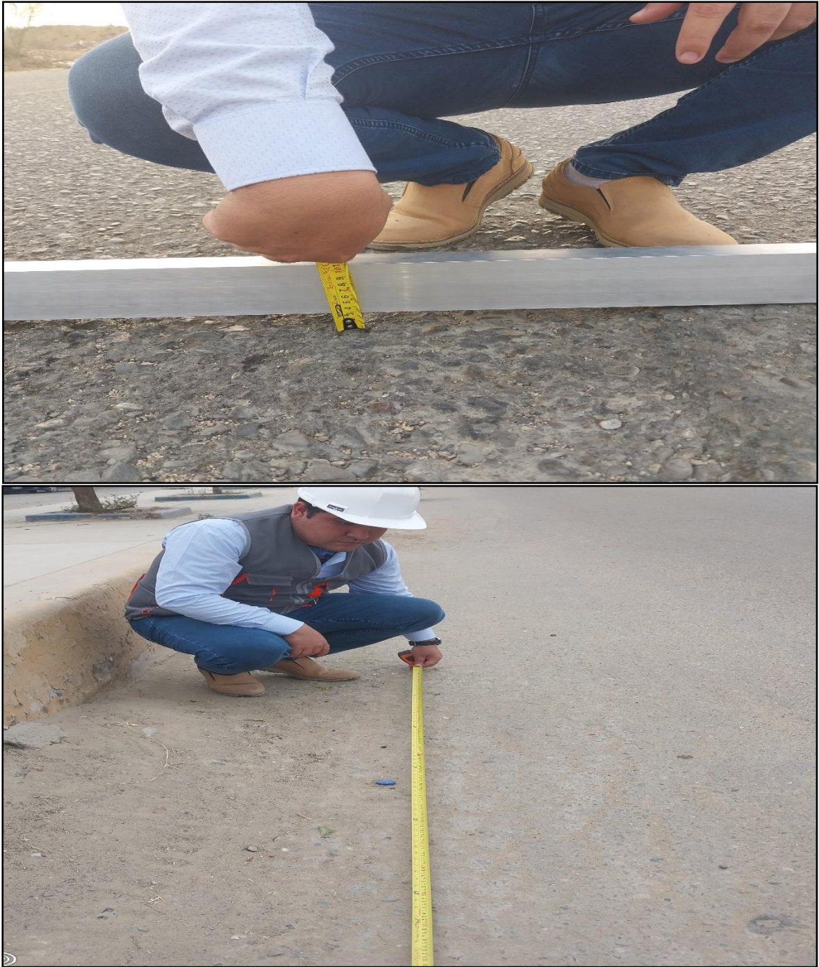
Panel fotográfico: Deterioros analizados Sección 8
