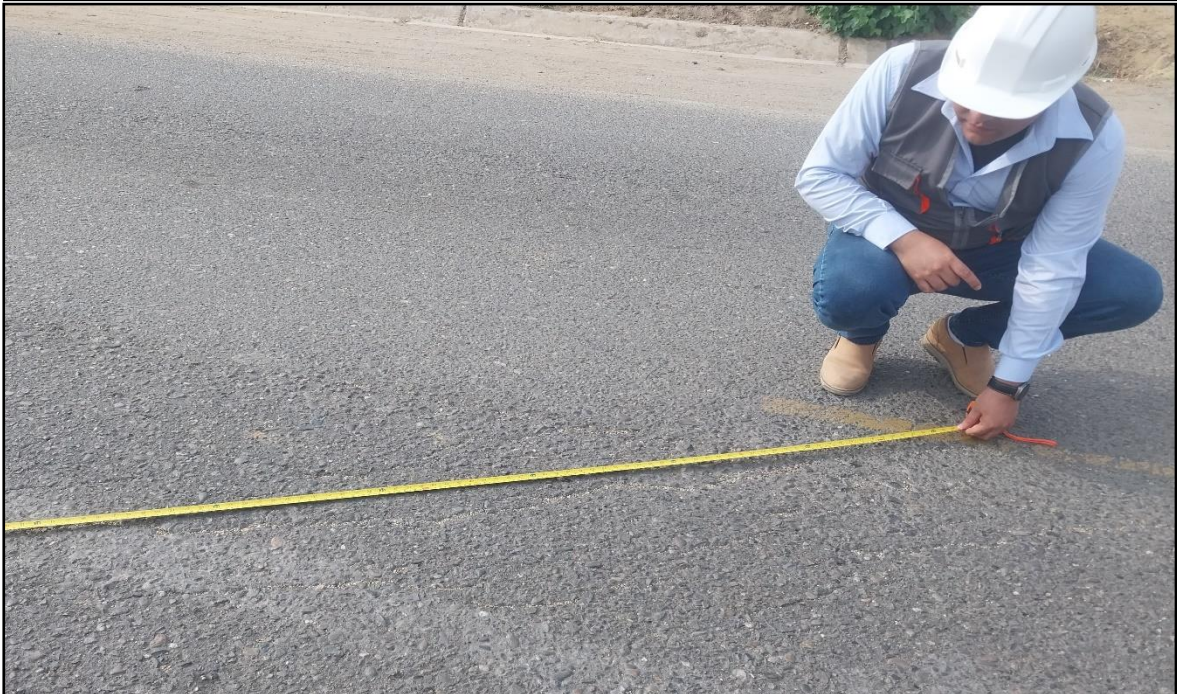
Panel fotográfico: Deterioros analizados Sección 18
