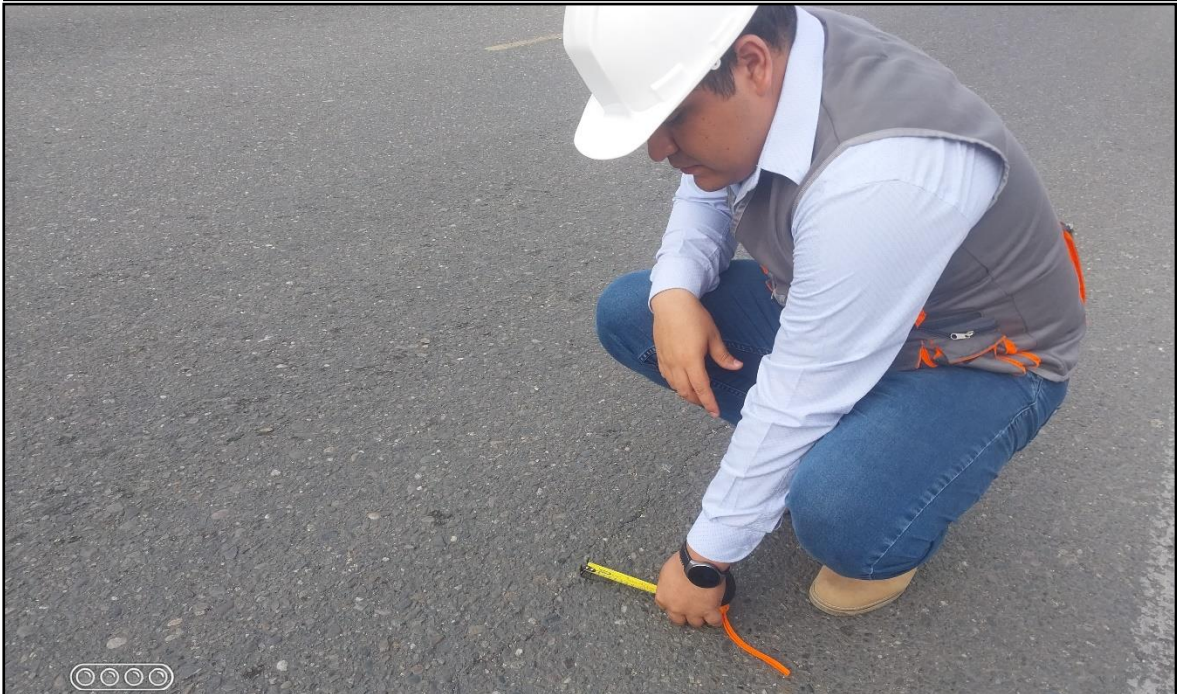
Panel fotográfico: Deterioros analizados Sección 6
