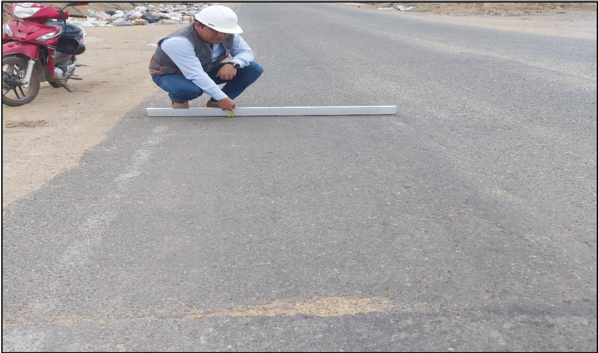
Panel fotográfico: Deterioros analizados Sección 12
