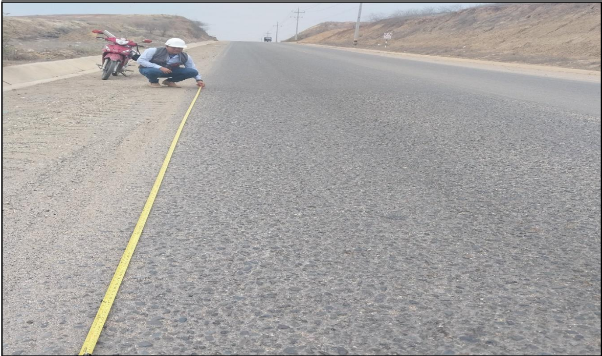
Panel fotográfico: Deterioros analizados Sección 13
