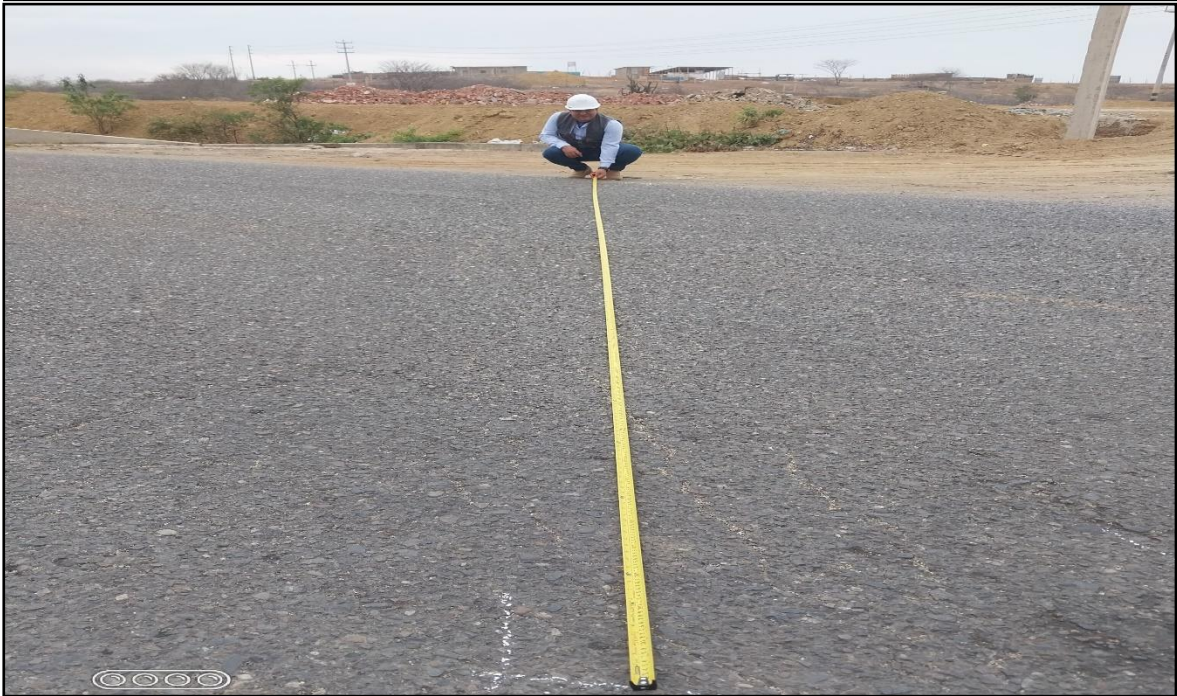
Panel fotográfico: Deterioros analizados Sección 11
