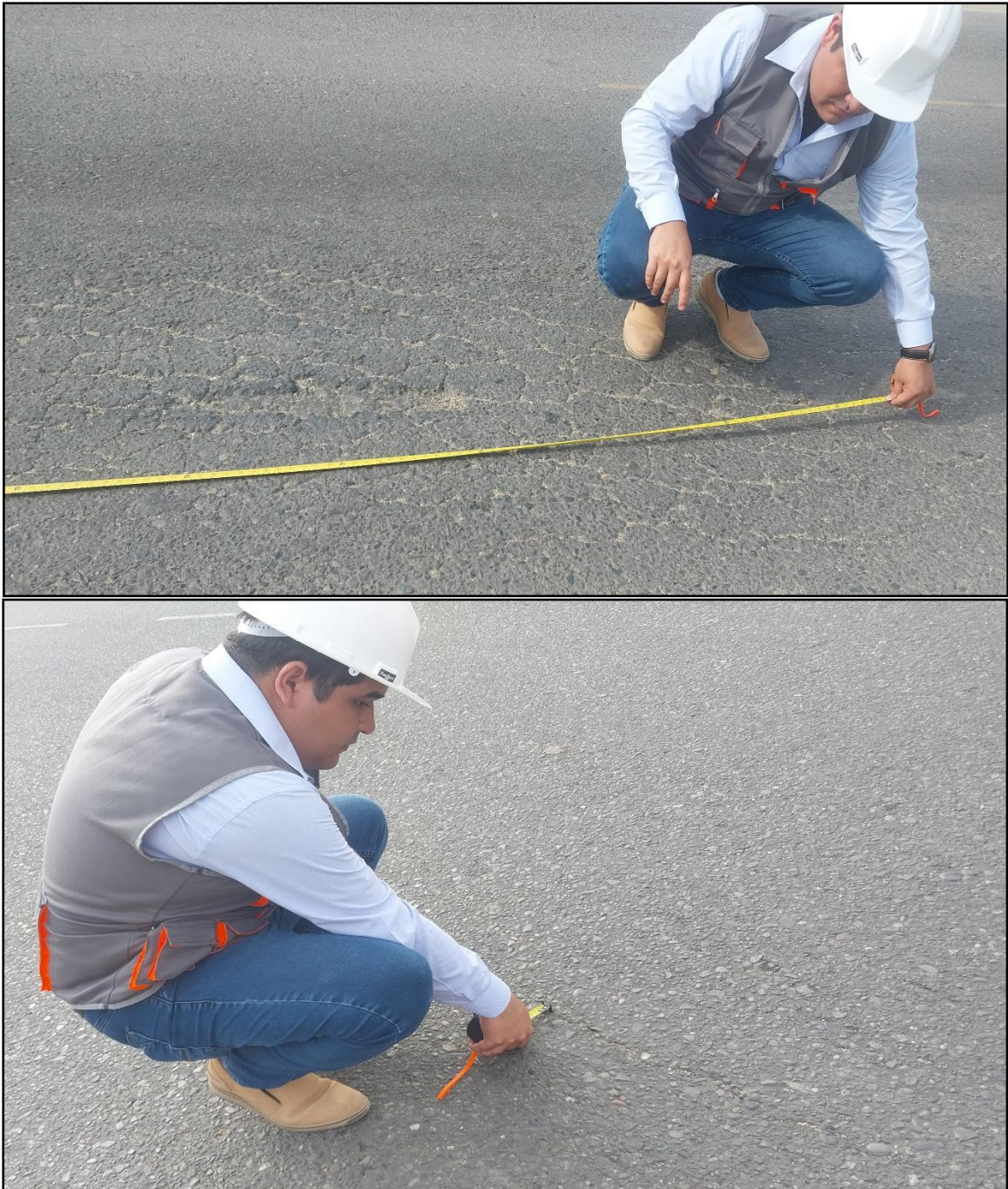
Panel fotográfico: Deterioros analizados Sección 10
