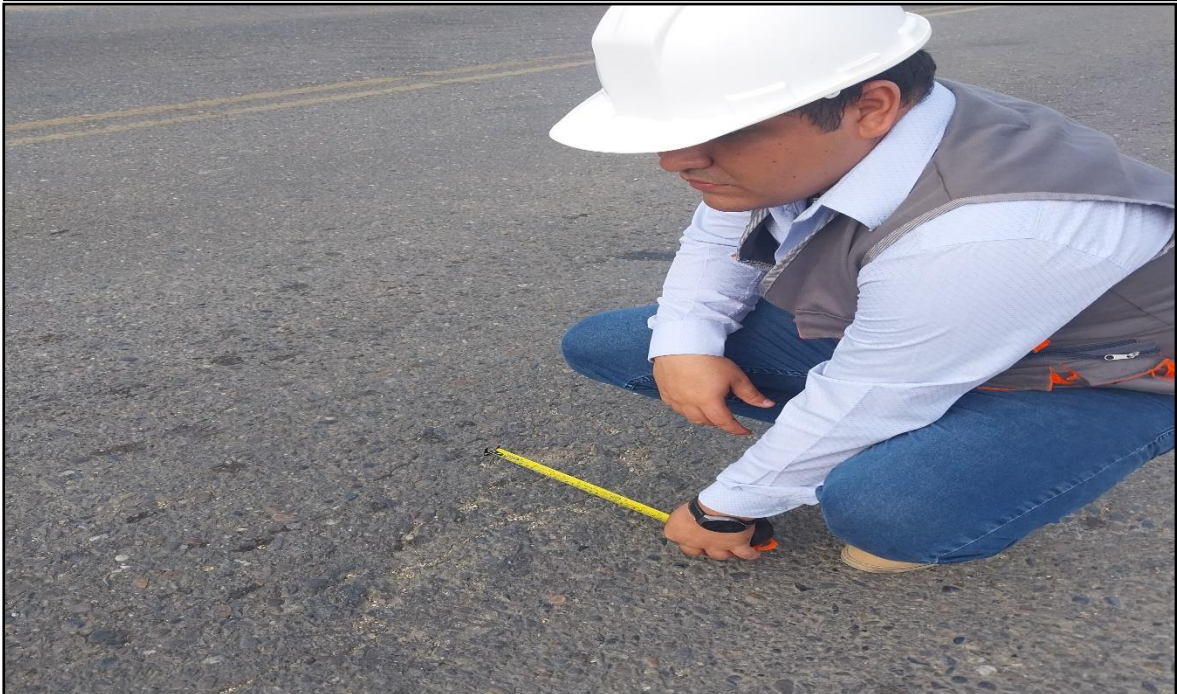
Panel fotográfico: Deterioros analizados Sección 3
