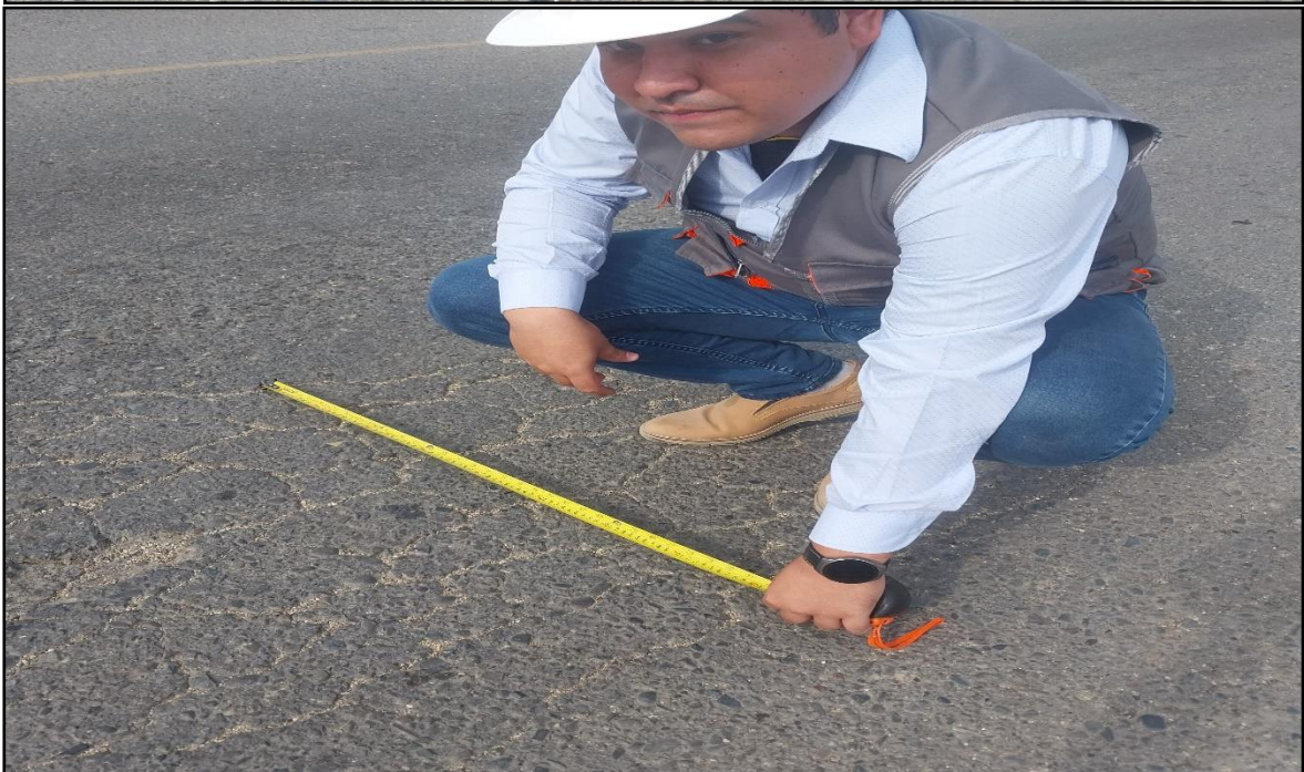
Panel fotográfico: Deterioros analizados Sección 9
