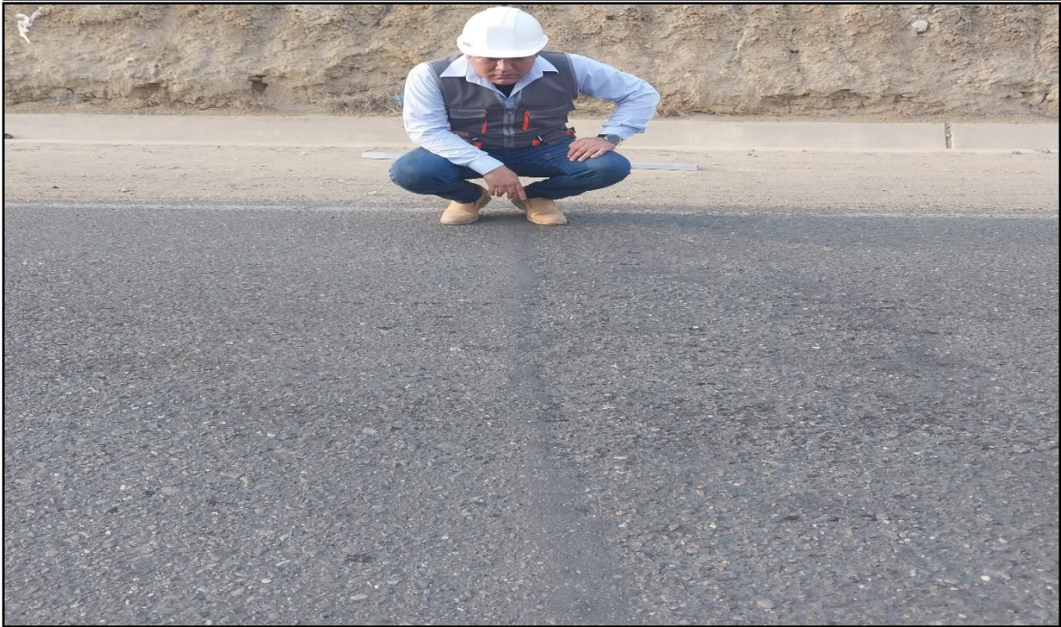
Panel fotográfico: Deterioros analizados Sección 22
