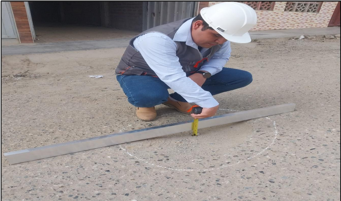
Panel fotográfico: Deterioros analizados Sección 17
