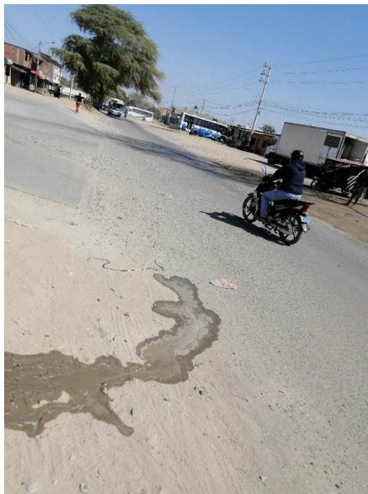
Figura 10: Av. Grau entre Psj 79 y Av. Raúl Mata la Cruz, deteriorada 04
