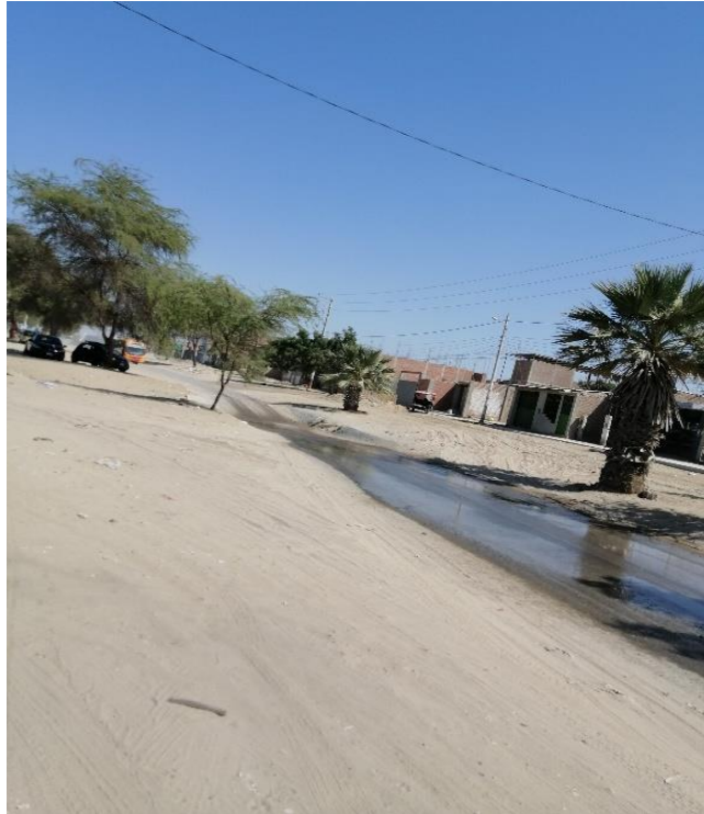
Figura 09: Av. Grau entre Psj 79 y Av. Raúl Mata la Cruz, deteriorada 03
