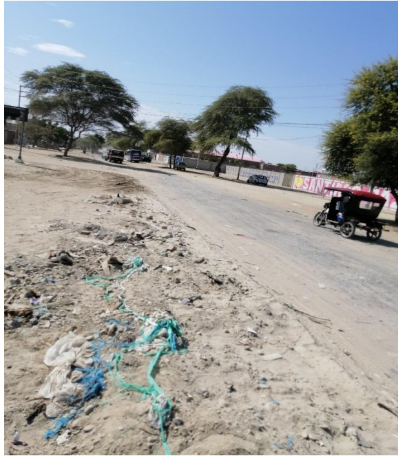
Figura 7: Av. Grau entre Psj 79 y Av. Raúl Mata la Cruz, deteriorada
