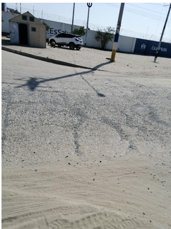
Figura 13: Av. Grau entre Psj 79 y Av. Raúl Mata la Cruz, deteriorada 07
