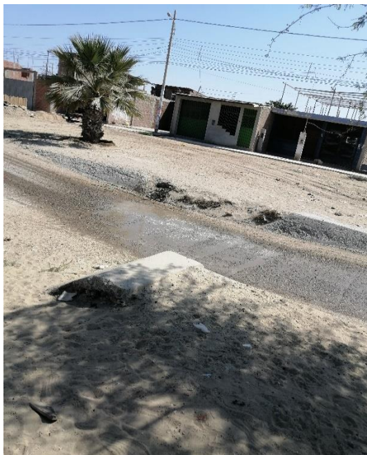
Figura 8: Av. Grau entre Psj 79 y Av. Raúl Mata la Cruz, deteriorada 02
