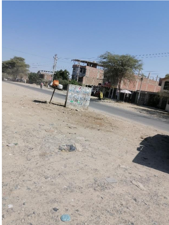
Figura 11: Av. Grau entre Psj 79 y Av. Raúl Mata la Cruz, deteriorada 05
