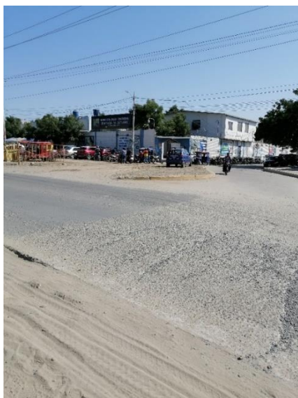
Figura 14: Av. Grau entre Psj 79 y Av. Raúl Mata la Cruz, deteriorada 08
