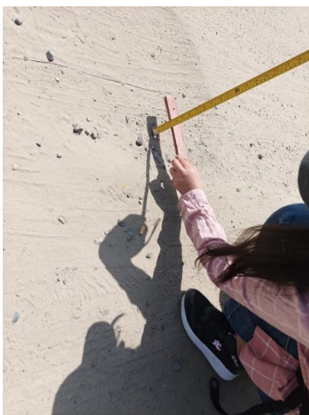
Figura 21: Huecos con severidad media
