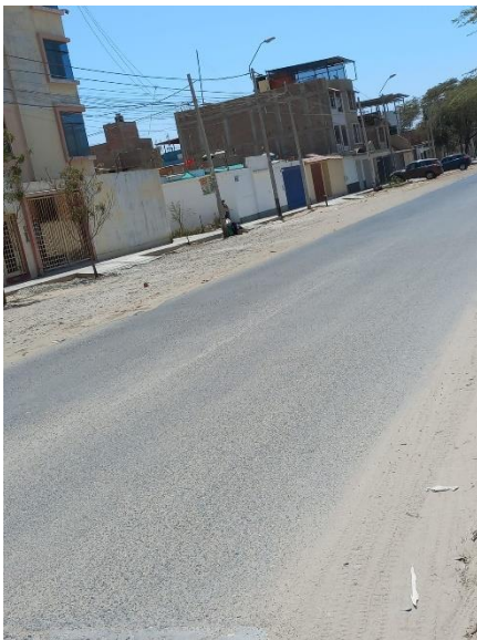
Figura 25: Desprendimiento de agregados con severidad media
