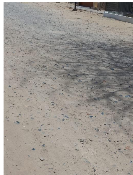
Figura 26: Pulimento de agregados con severidad media
