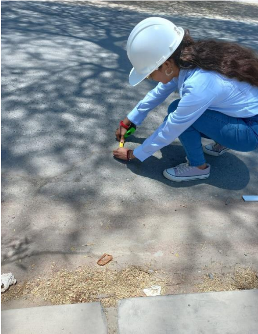
Figura 19: Grieta longitudinal con severidad baja
