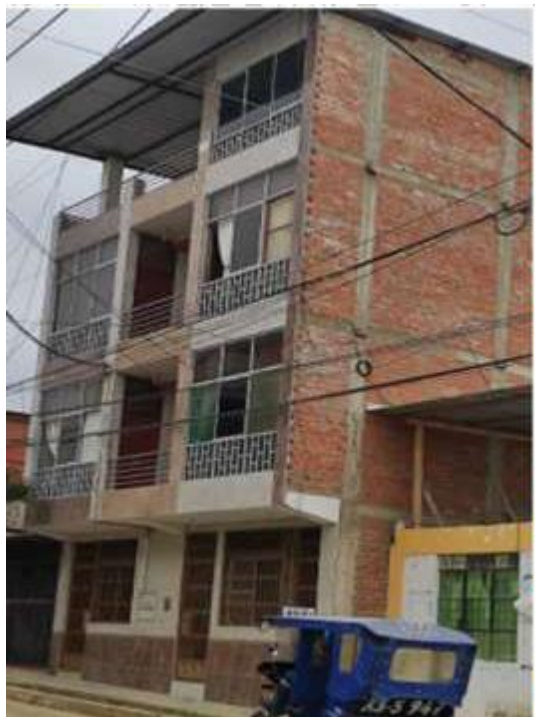
Figura 10: edificación C-11 con buena calidad del sistema resistente. Se califica con A
