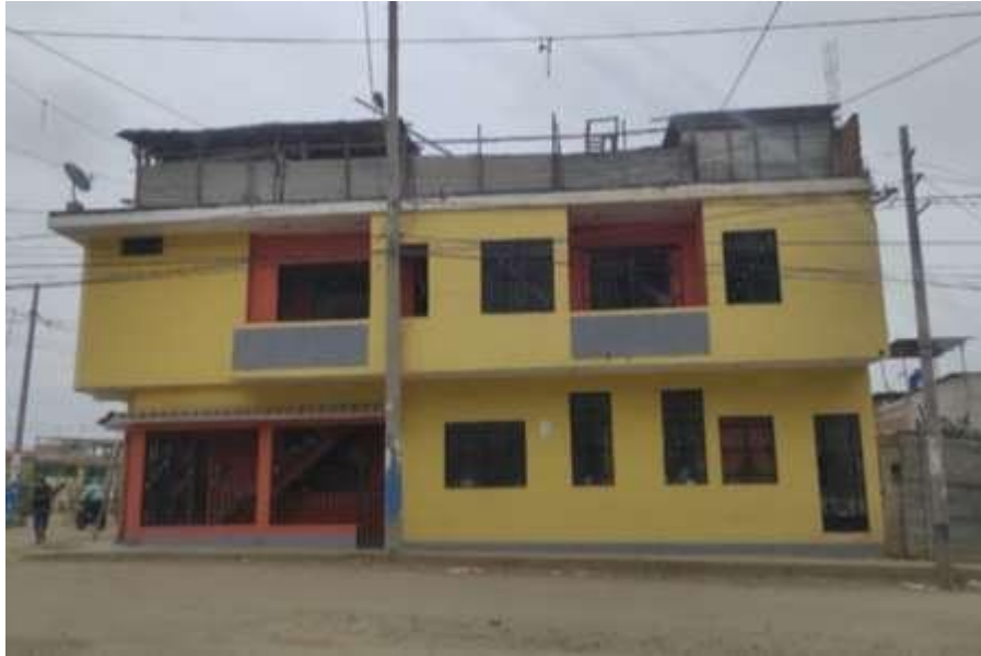
Figura 26: edificación C-19 muestra una cubierta fijada de manera precaria al sistema resistente. Se le calificó con D Fuente: propia
