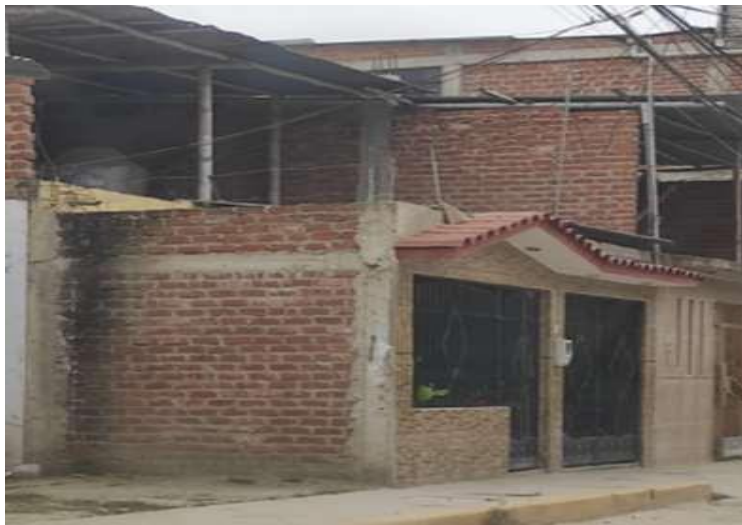
Figura 19: vivienda C-13 con muros sin columnas y/o confinamiento en el 2do nivel. Se le asignó una D en este aspecto
