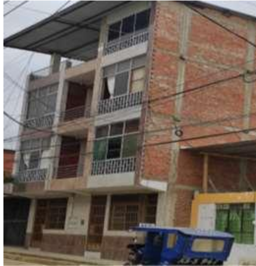
Figura 22: correcta cercanía entre columnas de la edificación C-11 presupone la cercanía de muros transversales. Calificó con C en este aspecto
