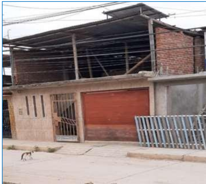
Figura 7: fotografía actual de la edificación C-1. Muestra muros sin confinar y falta de columnas en el 2do nivel. Se evaluó con D para este parámetro
