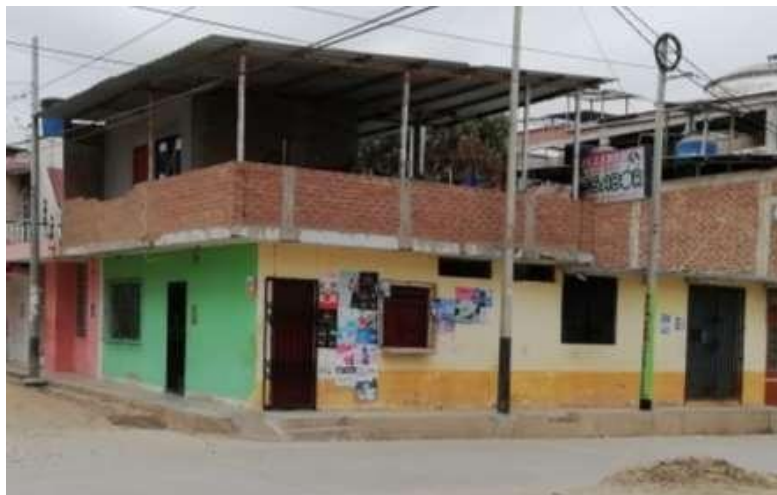
Figura 20: edificación C-14 con una habitación de mampostería de dimensiones considerables en el segundo nivel configura un problema en altura
