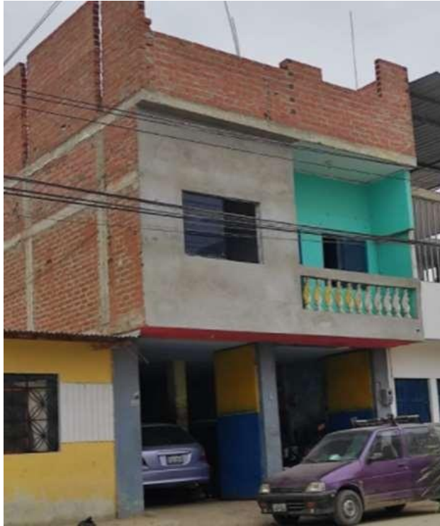
Figura 12: edificación C-6 con problema de irregularidad de resistencia (en altura)
