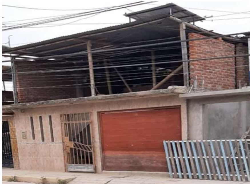
Figura 29: elementos sueltos y cañas de Guayaquil sobre la losa en la edificación C-1. No hay columnas ni vigas. Calificación D Fuente: propia
