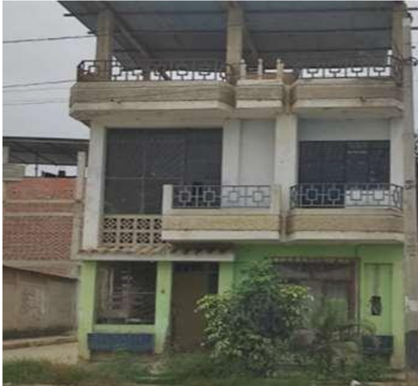
Figura 32: ejemplo de edificación (C-7) con mal mantenimiento. La calificación para C para ella Fuente: propia
