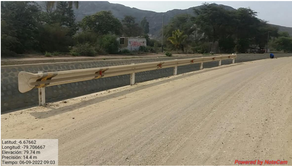
Figura 15 Guardavía encontrado en el tramo Vichayal-Luya
