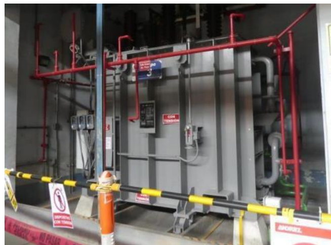
Figura 9. Transformadores de Potencia.
