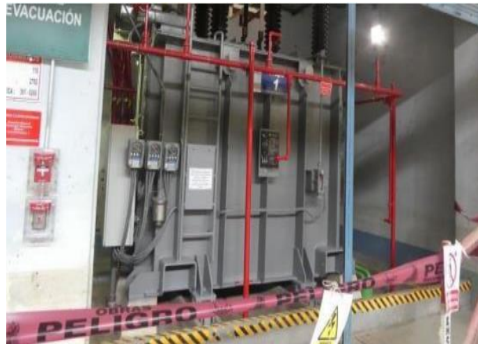
Figura 8. Transformadores de Potencia
