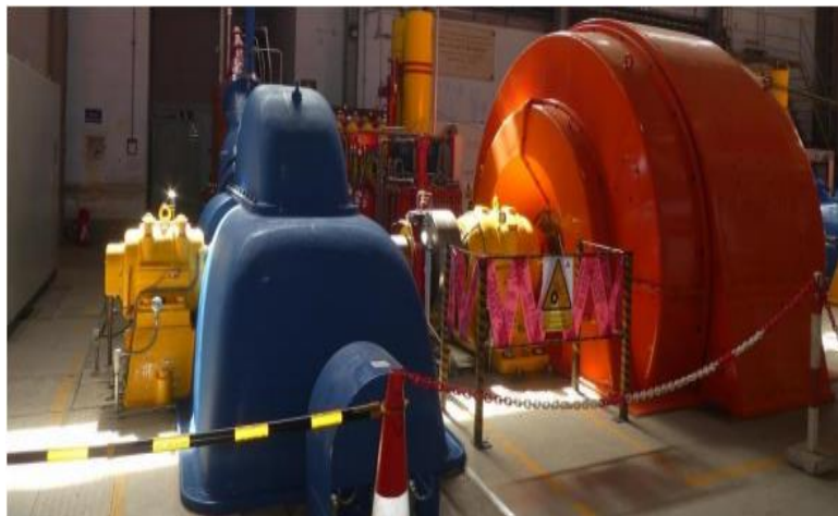
Figura 5. Unidad de Generación N° 2.
