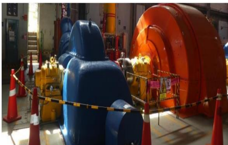
Figura 4. Unidad de Generación N° 1.
