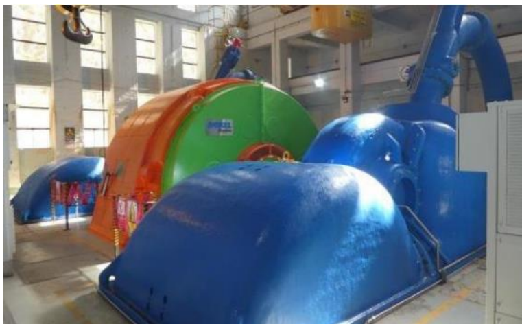
Figura 7. Unidad de Generación N° 4.
