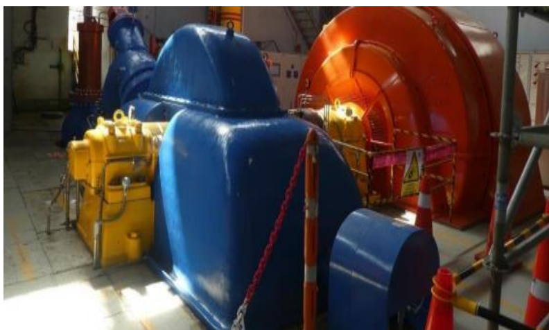
Figura 6. Unidad de Generación Nº 3.
