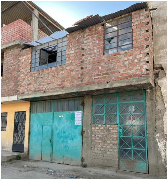
En esta imagen podemos ver una vivienda con una antigüedad de más de 15 años construida con dos materiales adobe y ladrillo.
