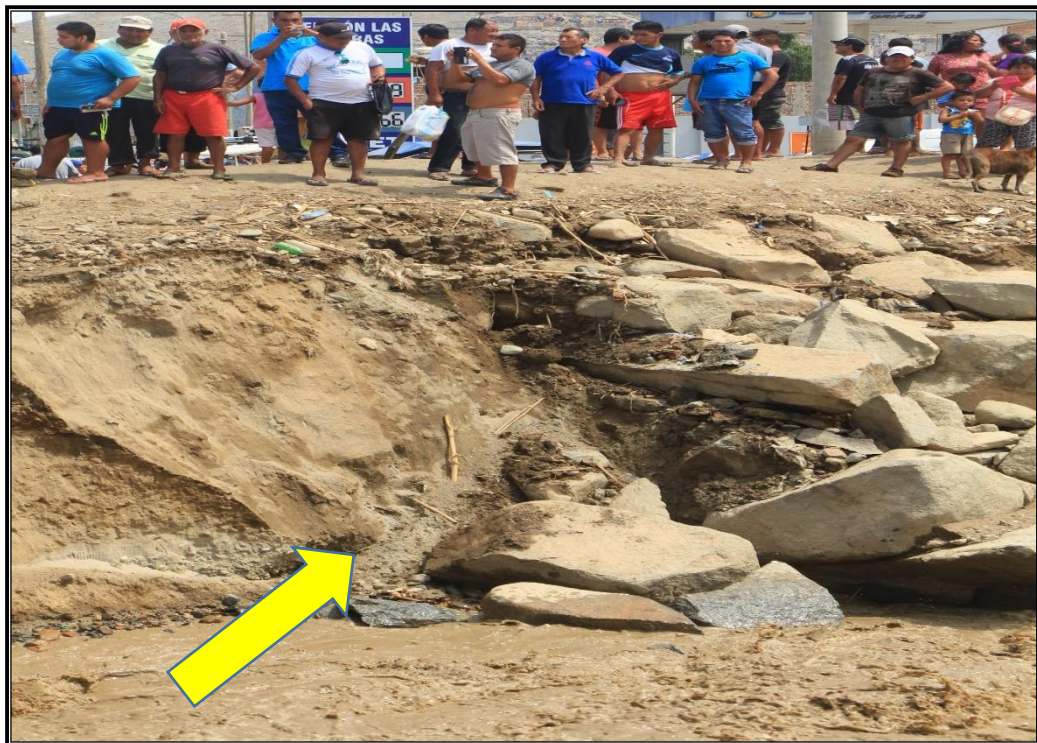
Ilustración N°8: Deslizamiento del enrocado existente con material propio, el área que indica la flecha es el margen que se puede mejorar con defensas ribereñas.
