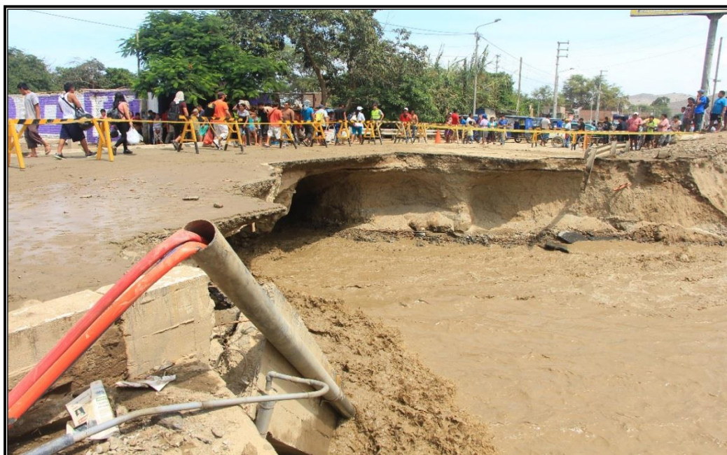
Imagen N°5: Vista de los daños producidos en el puente del Rio Sechin, producto del aumento del caudal.
