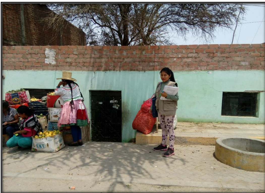
Imagen N°15: Se aprecia una de las viviendas que presentó mayor vulnerabilidad ante el desborde del río.
