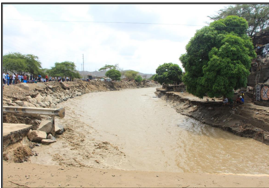
Imagen N° 6: Margen derecho del cruce del Puente Sechín, sector Cuncan, se aprecia que el agua viene golpeando y socavando el dique.
