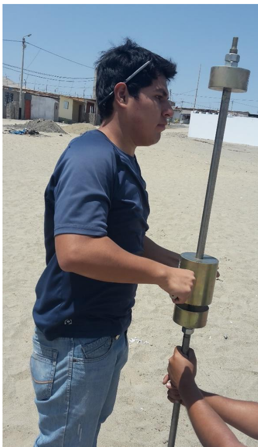
FOTOGRAFIA 03: Se realizó el ensayo de penetrometro dinámico ligero (DPL) a 3.00 m de profundidad.
