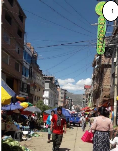
Viviendas que tienen azoteas sin techar e implementadas por tuberías de agua que salen de ese nivel hacia la vía pública.
