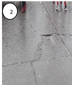
Pista del Jiron Juan de la Cruz Romero, con bache, con grietas
