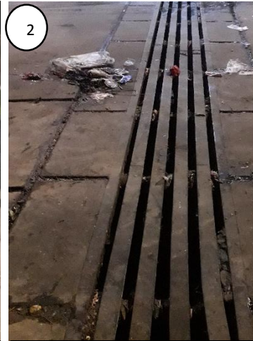
Alcantarillado con residuos sólidos a los costados en el Jirón Hualcan
