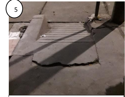
Vereda del jirón Hualcan , rajada, rota y desnivelada para acceder a la rampa peatonal
