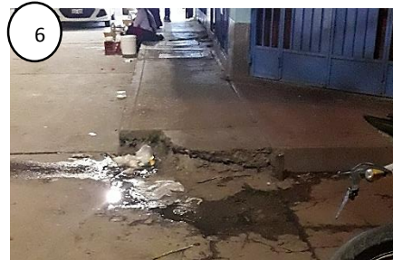
Inicio de la vereda del jirón Juan de la Cruz Romero totalmente destrizada
