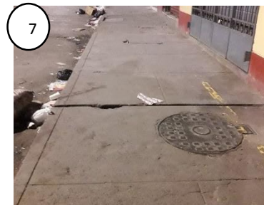
Vereda del jirón Juan de la Cruz Romero con grietas y ahuecado
