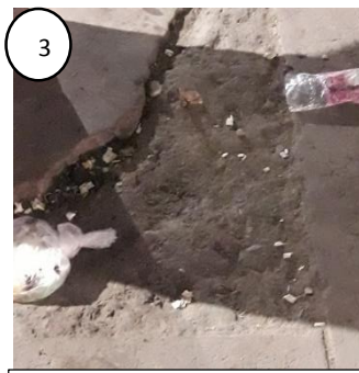
Vereda del jirón Hualcan con una gran rotura del concreto.
