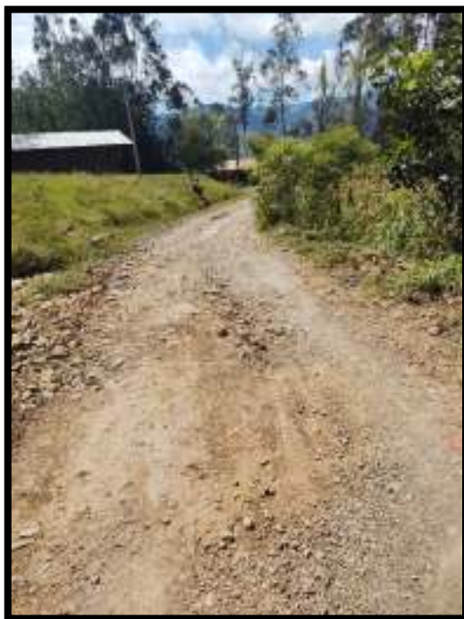
FOTO 02: Estado actual de la vía Yauyucan-Ninabamba en la provincia de santa cruz 2023 km 02.170m
