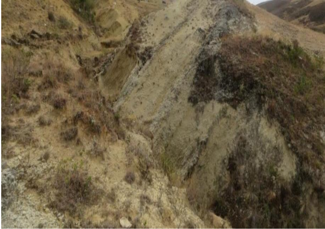
Figura 4. Erosión producida en estas rocas.
