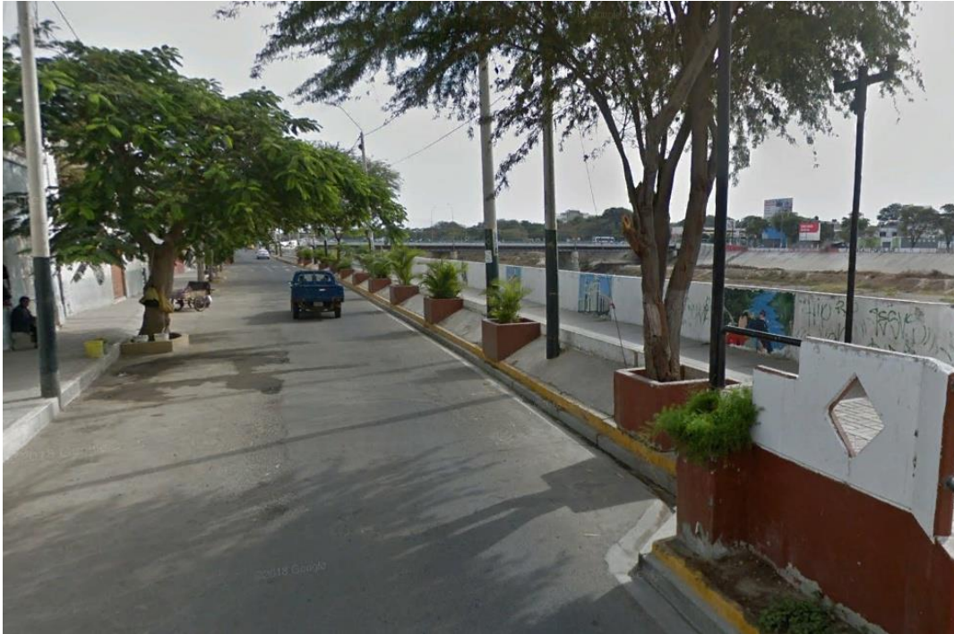
Figura 3: descascaramiento del muro de la fachada del malecón por falta de mantenimiento.
