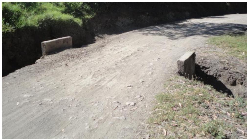
Figura 054. Alcantarillas que no cumplen el ancho requerido según el diseño geométrico actual.
