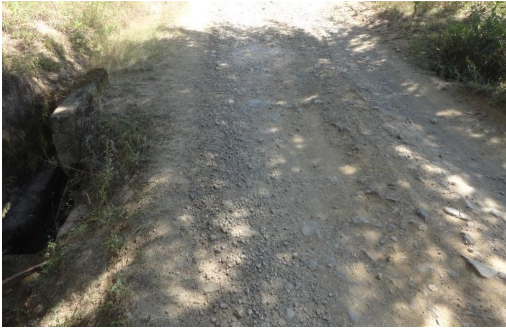
Figura 06. Aliviaderos con diámetros de 24" que no son aptos según el reglamento.
