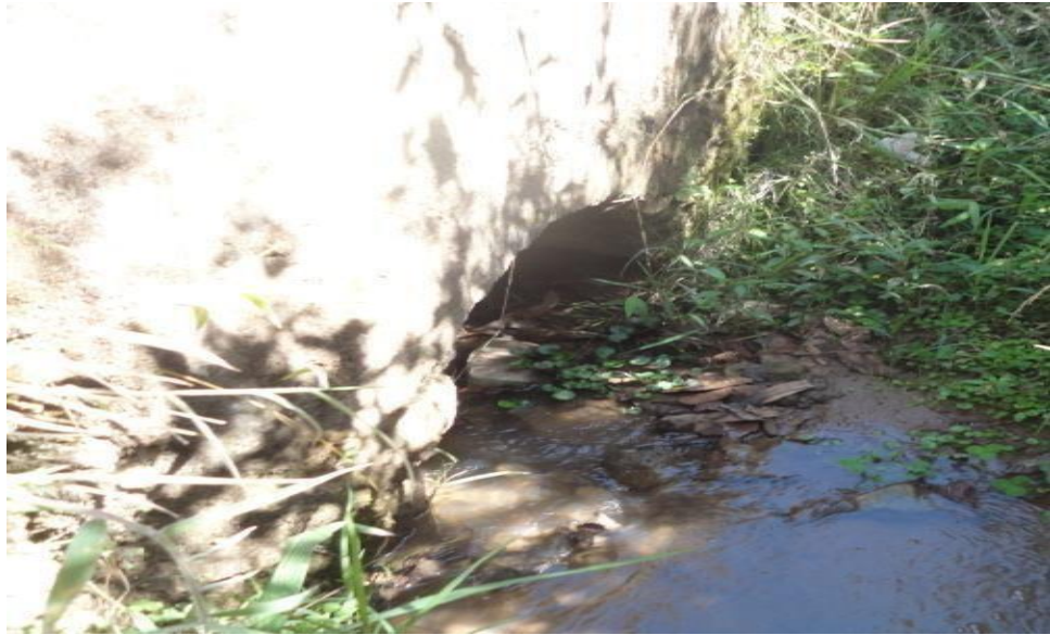
Figura 04. Alcantarillas totalmente colmatas, no cuenta con emboquillados a la entrada y salida
